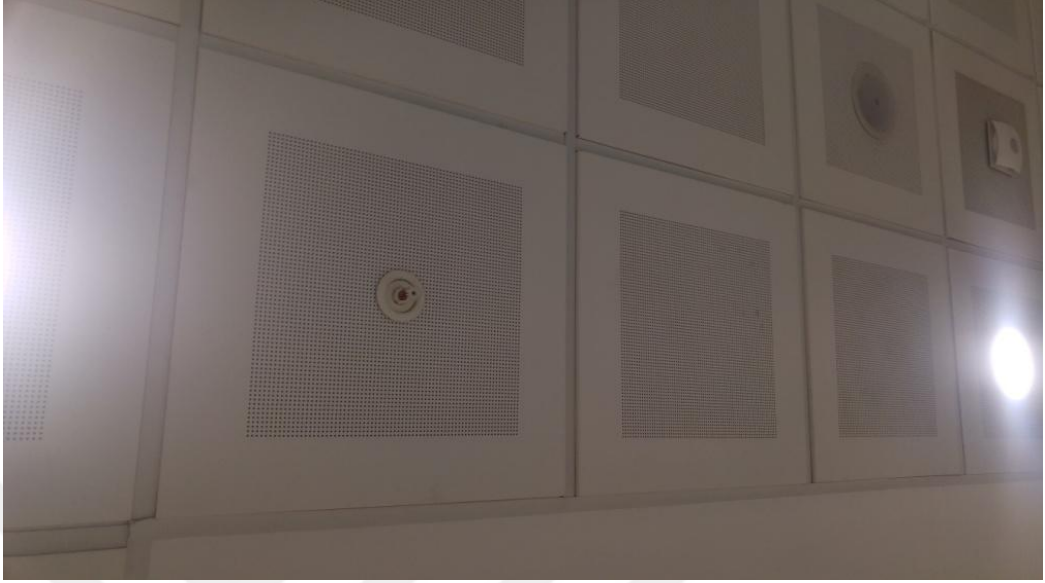
Şekil 5.40 Tavanda yer alan sprinkler (Güneş, 2019)
