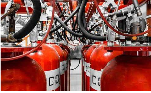
a) Gazlı söndürme sistemleri
