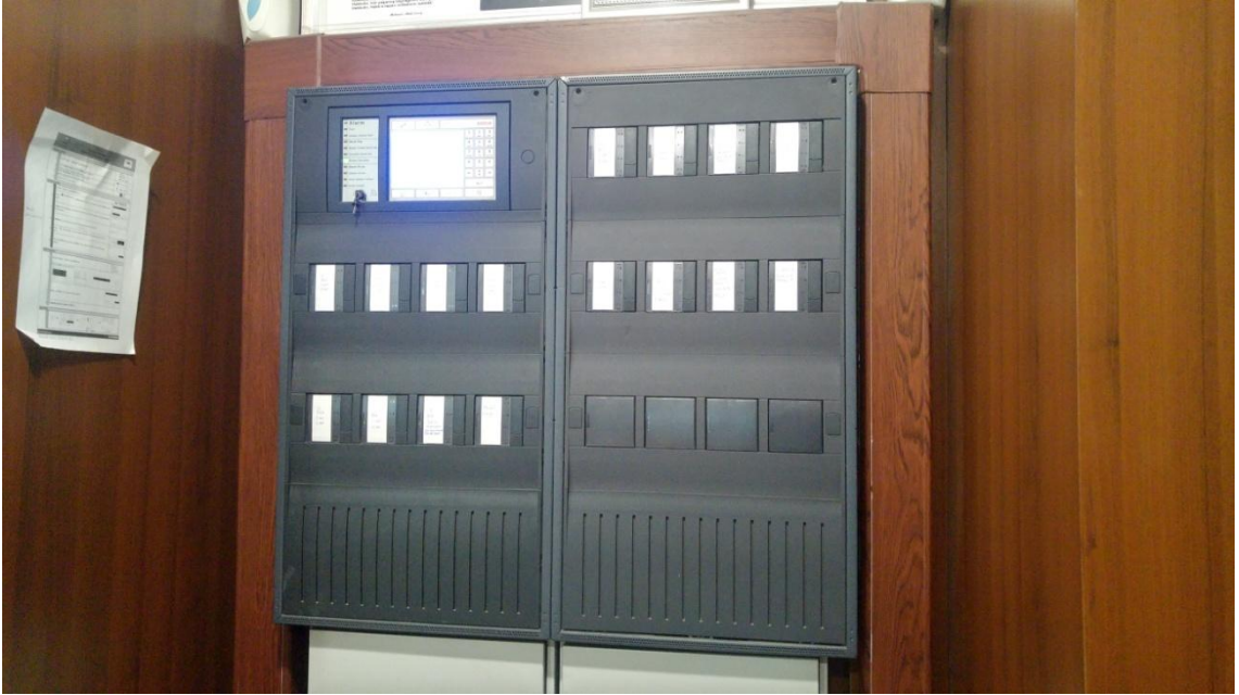
Şekil 5.38 Yangın uyarı panosu (Güneş, 2019)
