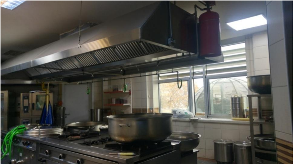
Şekil 5.36 Mutfağın davlumbazında yer alan söndürme tüpü ve dedektör (Güneş, 2019)
