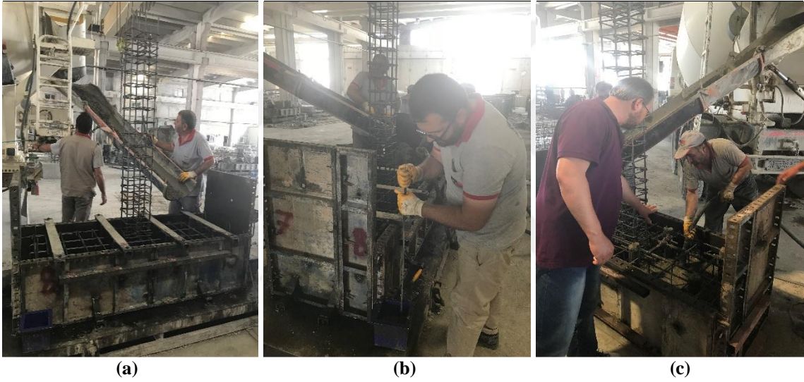
Şekil 3.8. a) Temel betonunun kalıba yerleştirilmesi b) Küp numune alımı c) Vibrasyon işlemi
