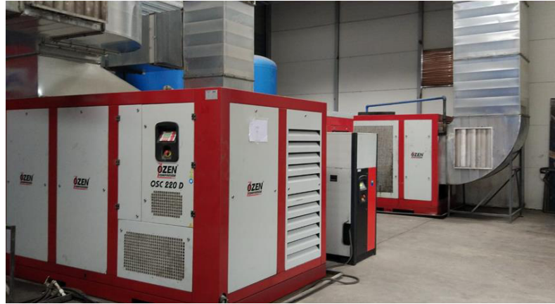
Şekil 4.6. Dövme bölümünde bulunan kompresör odasından bir görünüş
