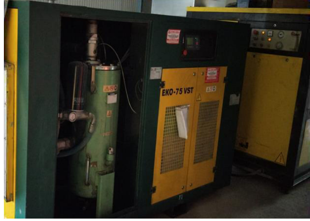
Şekil 4.5. Kauçuk burç bölümünde bulunan kompresör odasından bir görünüş
