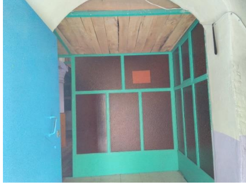
Resim 3.41. Kavaklı Agios Basileos Kilisesi, girişe eklenen demir doğramalı camekan
