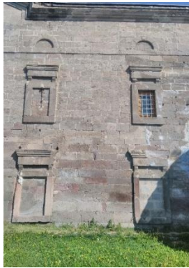
Resim 3.22. Surp Toros Kilisesi, güney cephesi kapatılan pencereler (2019)
