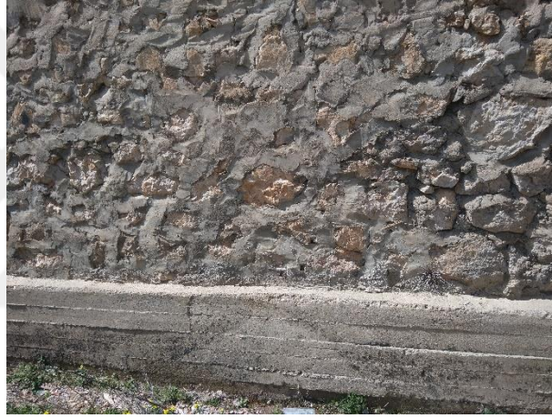
Resim 4.41. Faraşa Agios Ioannis Hrisostomos Kilisesi, güney cephesindeki çimento esaslı harç ve betonarme hatıl (2019)
