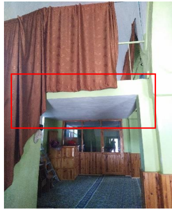
Resim 4.36. Faraşa Agios Ioannis Hrisostomos Kilisesi, sonradan eklenen betonarme döşemenin kuzey nefine uzanan kısmı (2019)
