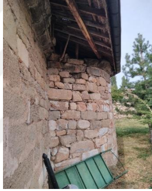
Resim 4.56. Kavaklı Agios Basileos Kilisesi, apsisin güneyine bakış ve diakonikon duvarından taşan çatı (2019)
