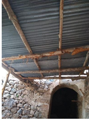
Resim 4.39. Faraşa Agios Ioannis Hrisostomos Kilisesi, apsise sonradan eklenen sac malzemeli örtü (2019)
