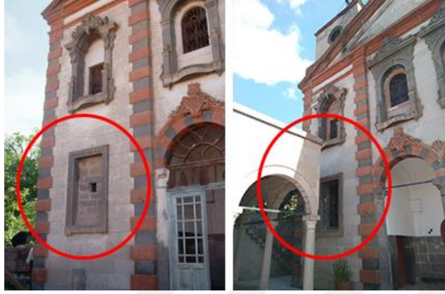
Resim 4.77. Tablakaya Panagia Kilisesi, merdiven mekânı penceresinin kapatılmış hali (Vakıflar arşivi, 2000)
