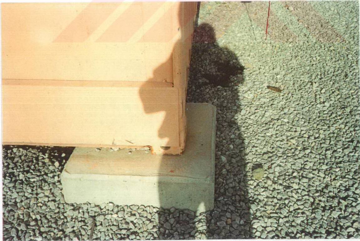
RESİM 17: Pano-İskelet-Temel Birleşimi. Korozyon Başlamış
