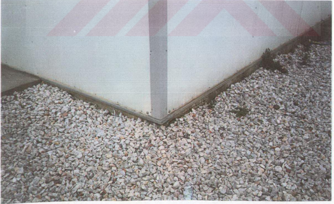
RESİM 27: Pano-Temel Birleşimi. Temel Toprağa Çok Yakın ve Yerden Su Emiliyor.
