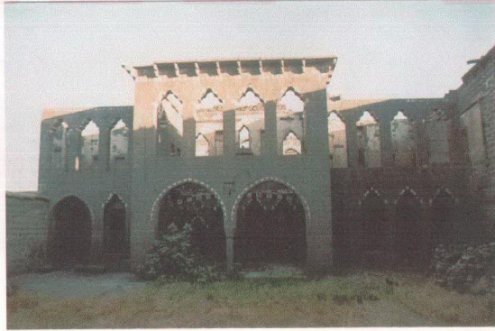
Resim 4. 11. Cemil Paşa Konağı Selamlık Bölümünde Yıkılmış Tavan Örtüsü
