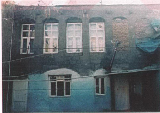
Resim 4. 9. Sülüklü Sokak No:12 de Cephe Düzeninin Bozulması
