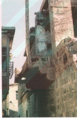
Resim 4. 16. Ziya Gökalp Mahallesi Puşucu Sokak No:13'de Yıkılmış Şahnişin
