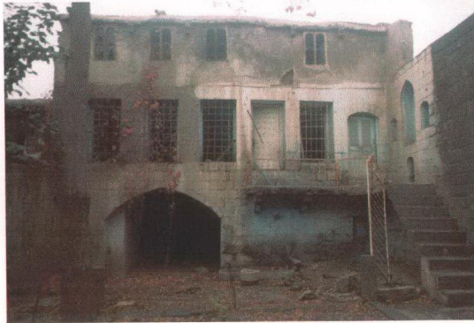
Resim 4. 4.Sülüklü Sokak No:38 Terkedilmiş Bir Ev
