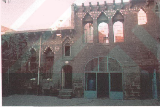
Resim 4. 15. Camii Kebir Mahallesi Ziya Gökalp Sokak No:1'de Tavanı Çökmüş Ev
