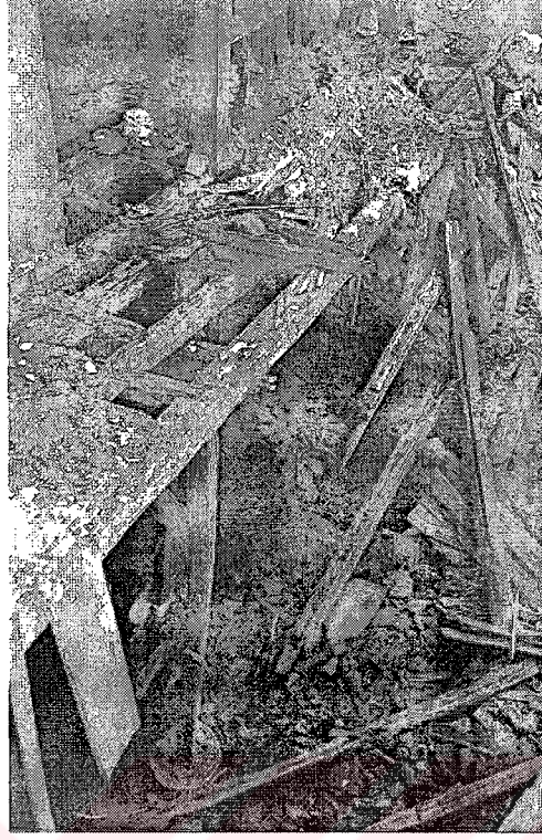
Fotoğraf 23 Cephe ve döşeme taşıyıcılarında bozulma (Fotoğraf: Dışkaya, H., Kırklareli)
