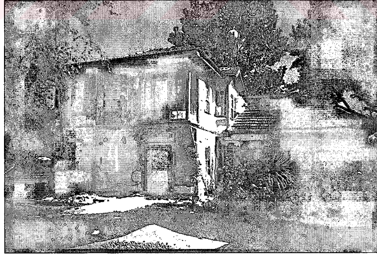
Fotoğraf 27 Düzce'de 12 Kasım depreminde zarar görmüş hımiş sistem bir yapı (Kaynak: Halûk Sezgin)
