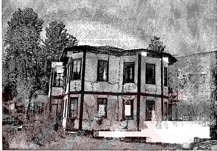
Resim 3. 3 12 Kasım 1999 Düzce depreminde hasar görmüş olan dolgulu ahşap karkas bir konut (Sezgin, H.)
