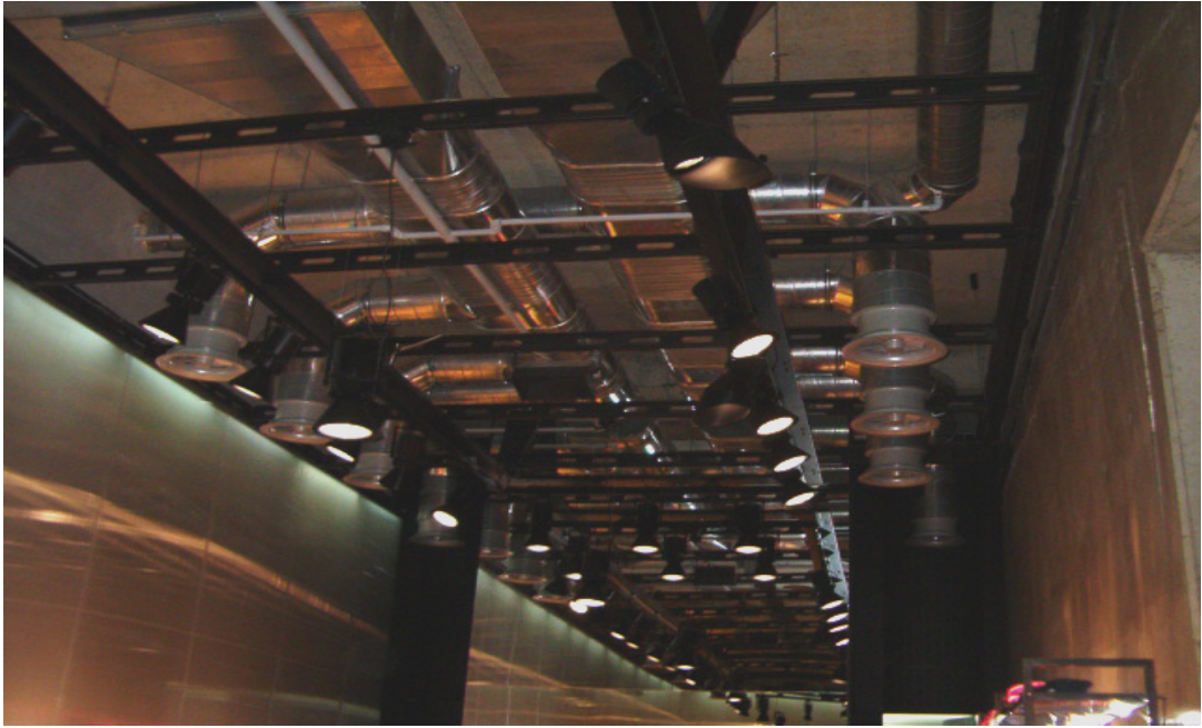
Şekil 4.35. Mağaza boyunca havalandırma ve aydınlatma sistemleri açık tutulmuş, siyaha boyalı metal I profillerle desteklenmiştir.
