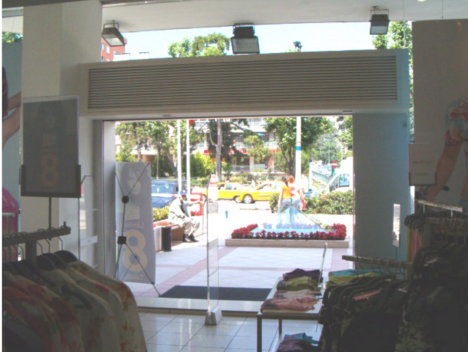
Şekil 4.3. Mağaza girişinin içeriden görünüşü. Klima kontrol sistemi ve güvenlik amaçlı sensörler görülmektedir.
