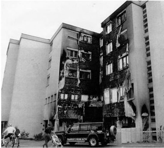
Resim 12 Apartment Building, Munich, 1996 [35]. Yanıcı cephe kaplamasının bir çöp varilinden alev alması sonucu cephe yangını oluşmuştur
