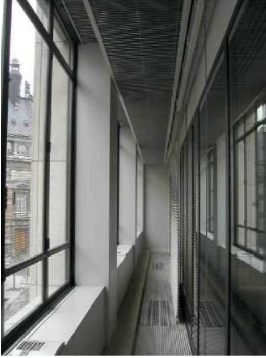
Şekil 2.25. Birçok oda karşısında uzayan boşluk, sürekli havalandırma delikleri yoluyla kontrolsüz havalandırma. [Loncour, X. 2004]
