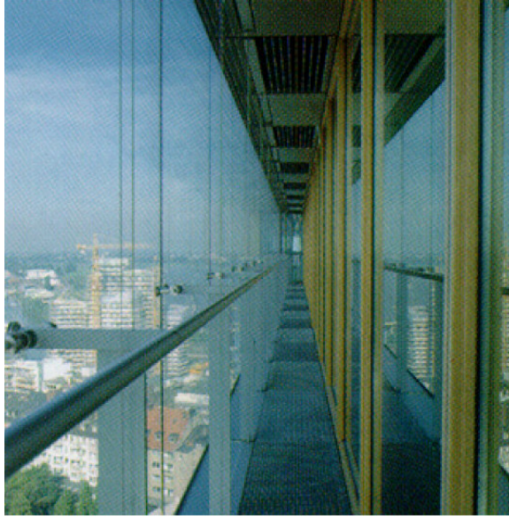
Şekil 3.26. Dış kabukta 12mm'lik temperli cam, iç kabukta low-e cam kullanılmış yapı örneği (Düsseldorf City Gate Binası, Almanya) [Poirazis,H. 2004]
