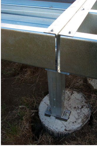
Şekil 3-123 Hafif çelik bileşik profil (kutu profil) ayakların ankraj bulonları ile betonarme tekil temellere montajı. [139]
