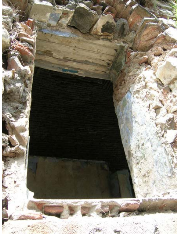
Foto C. 41- Sıbyan Mektebi güney cephesindeki bozulmuş pencere (2005)
