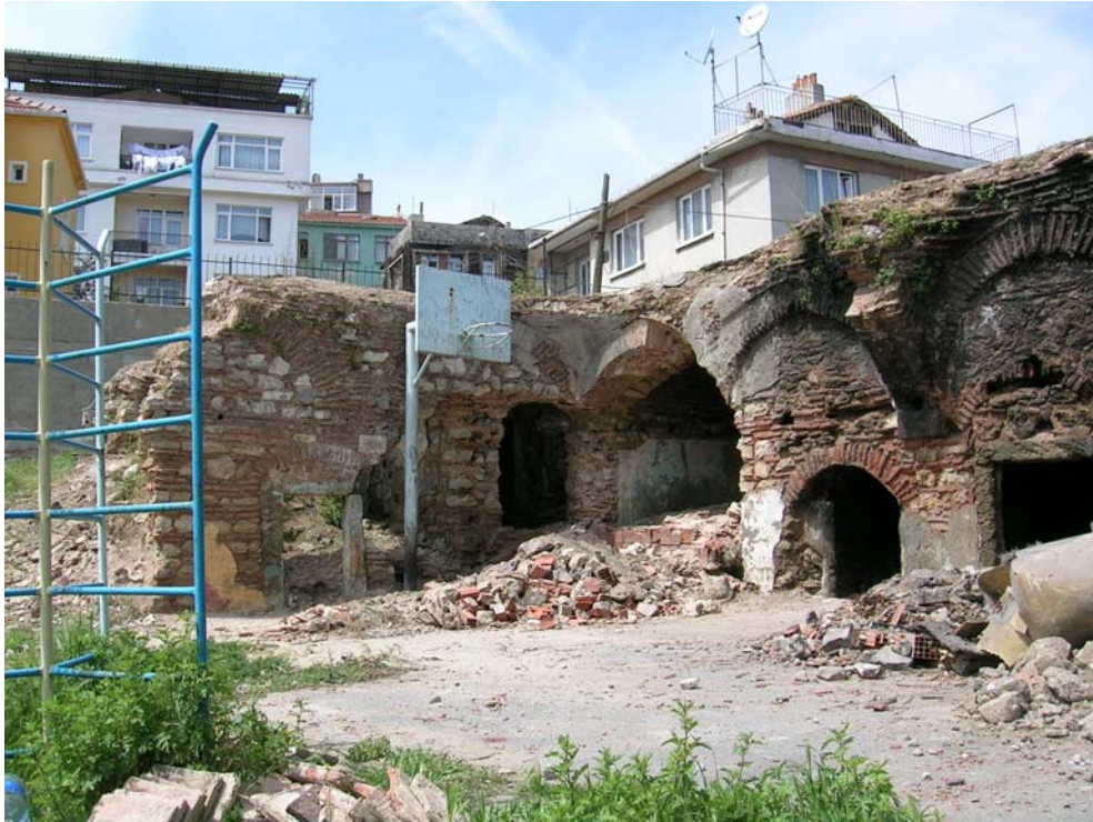
Foto C. 26- Yıkılan revaklar ve medresenin batı kanadı görünüşü (2005)
