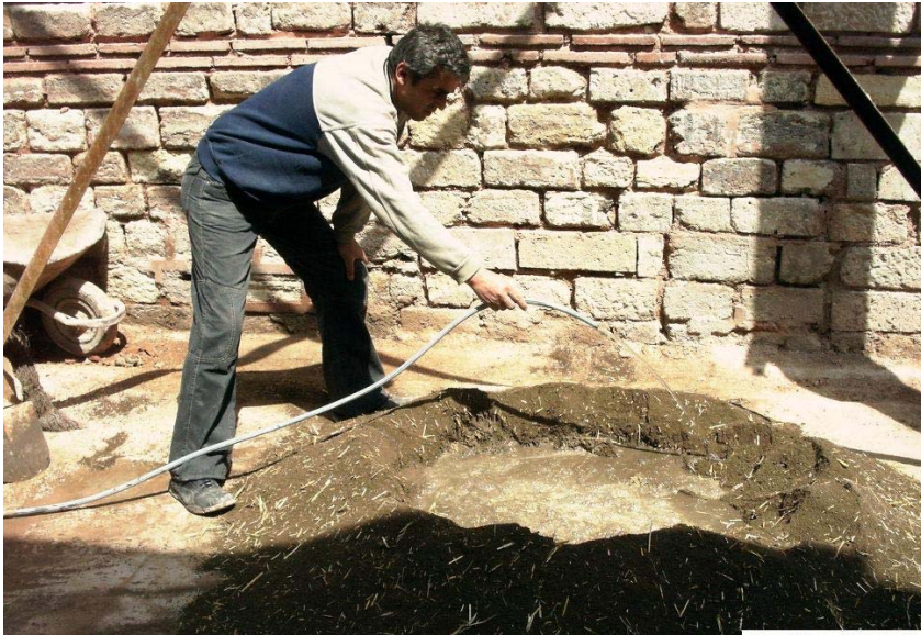
Foto 5.2. Fezullah Efendi Medresesi restorasyonu-Kubbelerin kurşun altı çamur sıvasının hazırlanması (Ak-Alay İnş. Arşivi)
