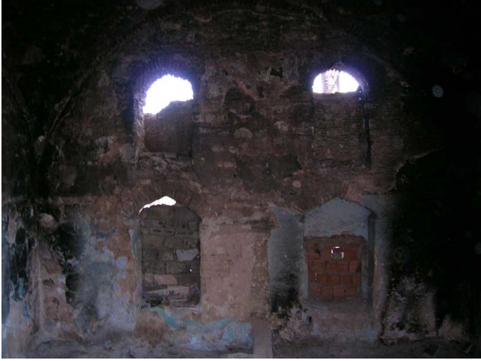
Foto C. 33- Dershane içinden görünüş- Yakılan ateş sonucu duvarlarda oluşan isler (2005)
