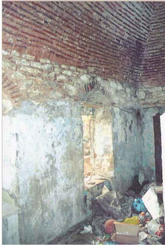
Foto C. 42- Sıbyan Mektebi dersliđi, pencerelerin kemer aynaları boşalmıř (2004)
