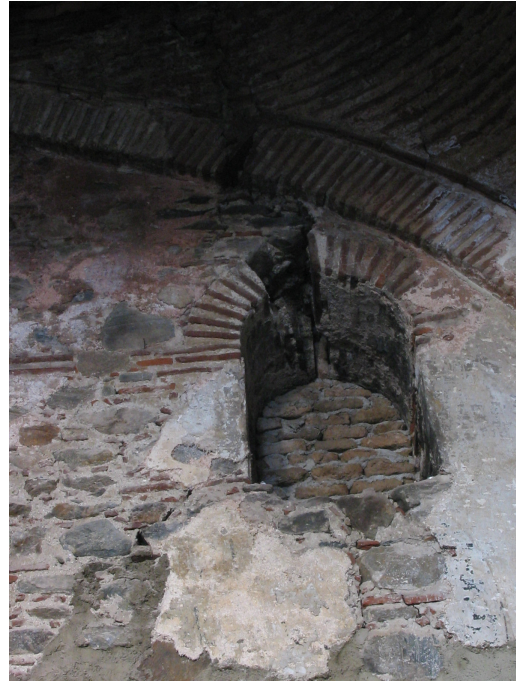
Resim 3.11 Gökdere Medresesi'nin Dersliğinde Güney duvarında bulunan kemerdeki çatlak. (Nisan 2005)
