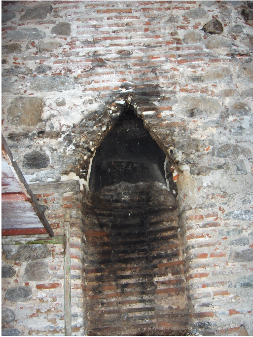
Resim 3.10 Gökdere Medresesi'nin hücrelerinde bulunan ocaklar. (Nisan 2005)
