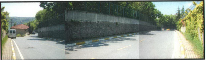
Fotoğraf 8-Nisan 2006- site duvarlarının yol üzerindeki etkisi.
