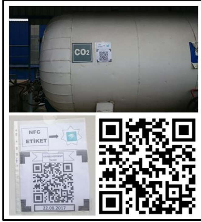
Şekil 125. Karbondioksit Tankı Karekod ve NFC Etiket Uygulaması
