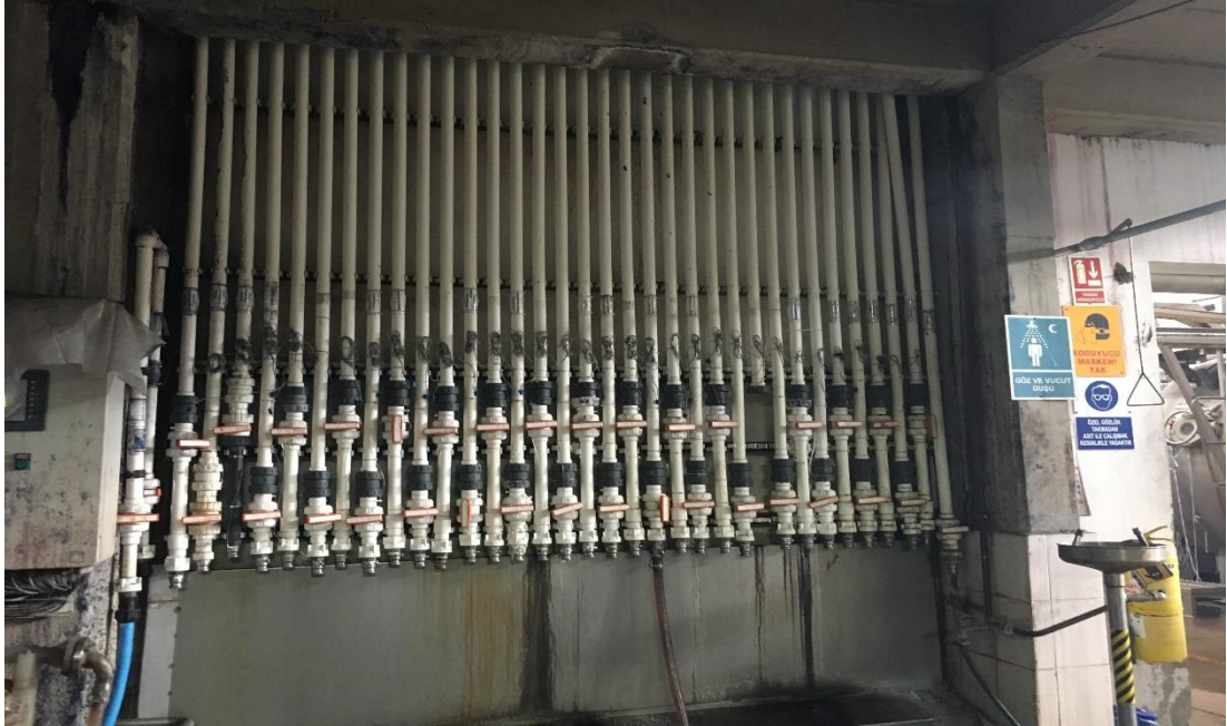
Şekil 15: Boya mutfağında borular
