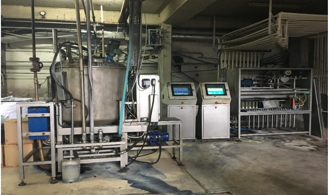
Şekil 13: Boya mutfağı otomasyon sistemi
