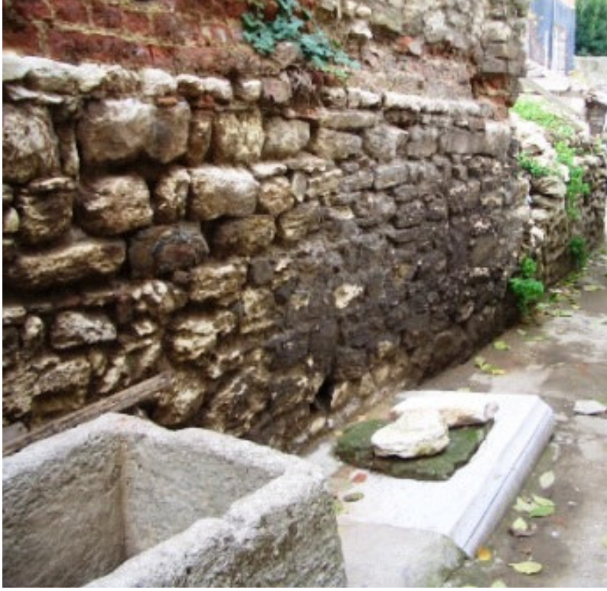
Foto C.3. 25 Türbenin arkası (Çıkmaz sokak)
