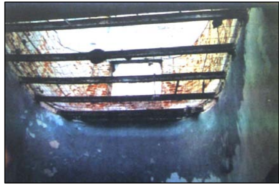
Resim 5.1: Akaretler Blokları-Döşemelerde korozyona uğramış elemanların yenilenmesi (Kaynak: Mevcut Binaların Lüks Otellere Dönüştürülme Olanakları ve Tasarlama Yaklaşımları, s.81)
