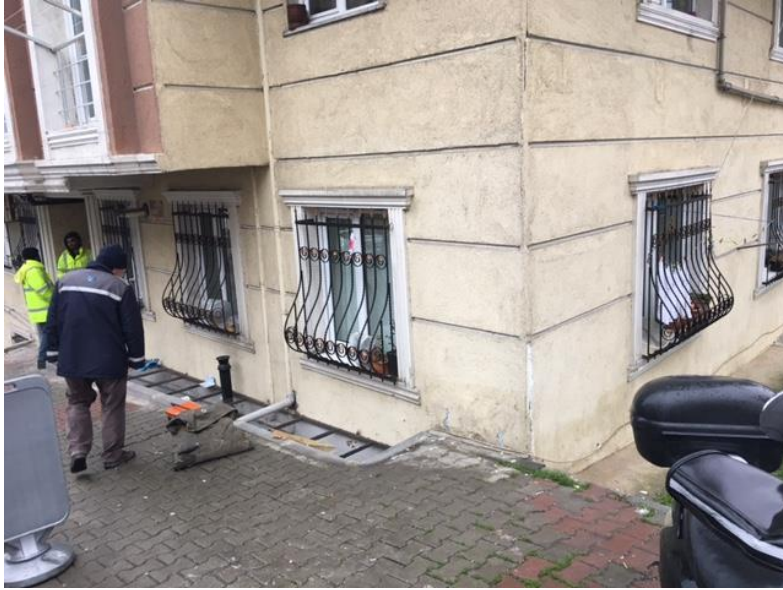
Resim 7 Hasar Gren Duvar Yzeyi
