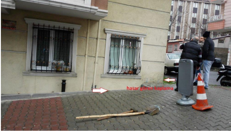
Resim 5 Menhol Kapağının Yerinden Fırlaması İle Hasar Gören Kaplama
