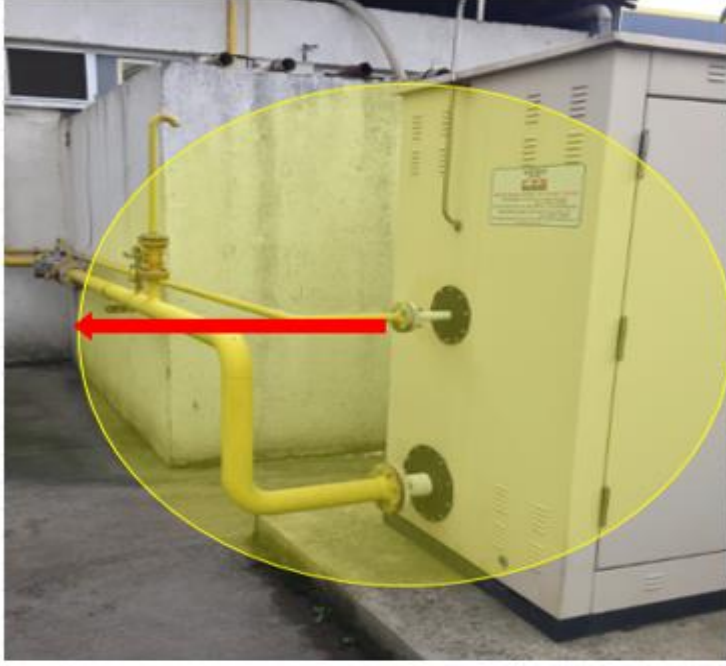
Resim 2 : Doğalgaz flansı tehlikeli bölge temsili görünümü
