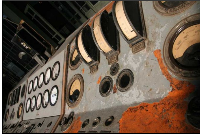
Şekil 5.9. Silahtarağa Elektrik Santrali Makine Dairesinden Bir Görünüm
