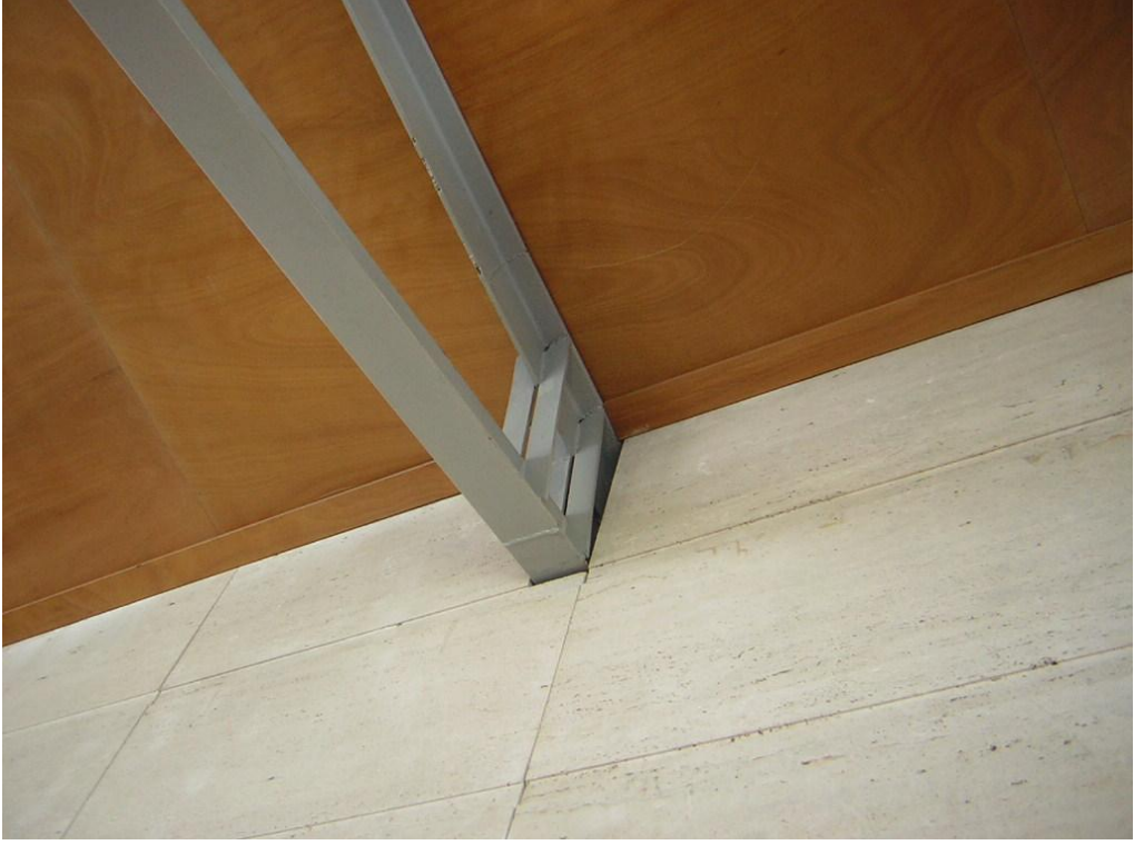
Şekil 4.29. Çatı makasının duvar ve çatı ile birleşim noktasında malzeme ve renk farklılığı.
