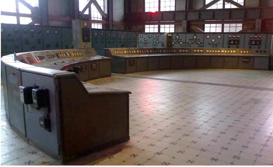
Şekil 3.73 Santral İstanbul Enerji Müzesi Kontrol Odası Günümüz (Bürkan Emre Arşivi)
