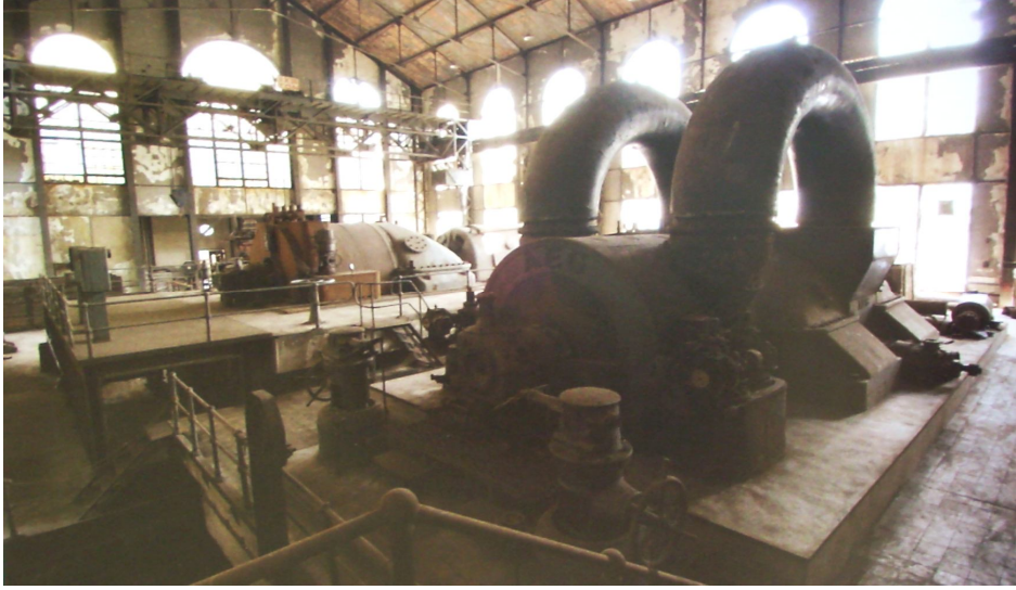
Şekil 3.70 Silahtarağa Elektrik Santrali AEG Marka Türbin 2004
