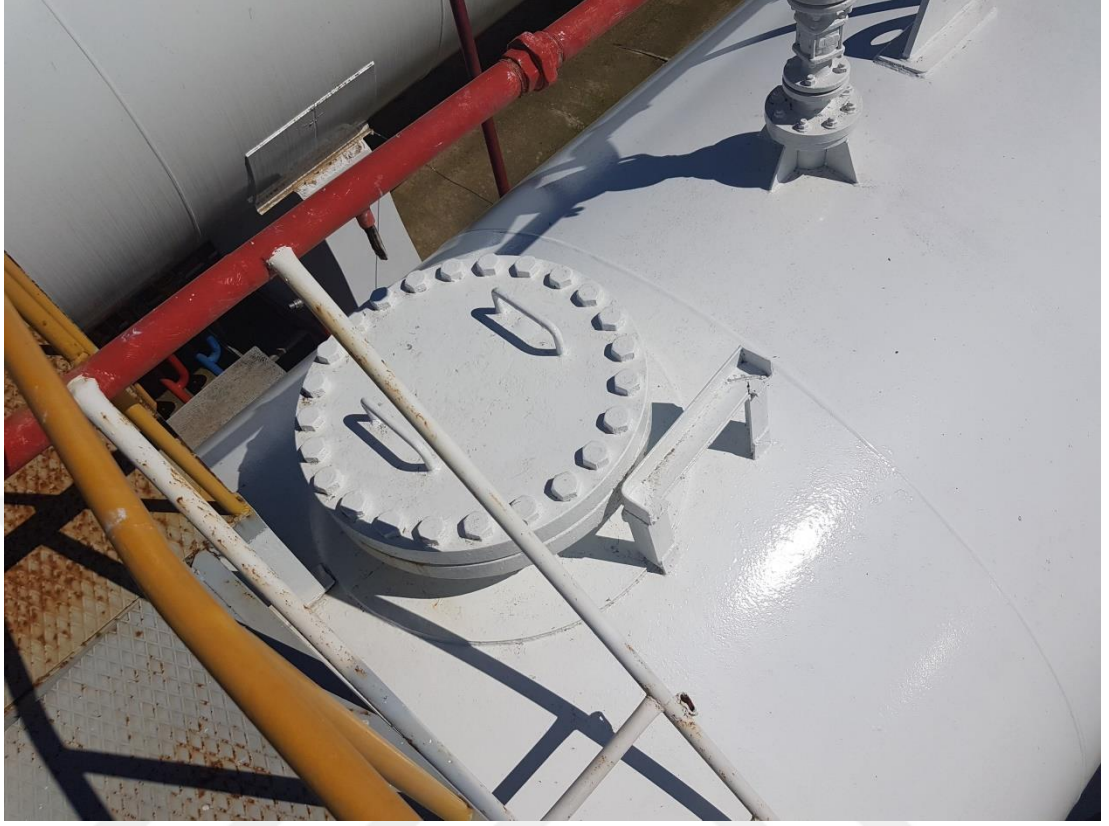
Şekil 8. Tankın bakım ve temizliđi için kullanılan melon kapađı ve girişı
