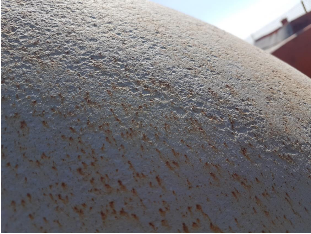
Şekil 2. Korozyona Bağlı Oluşan Metal Yüzeyindeki Oyuklar.
