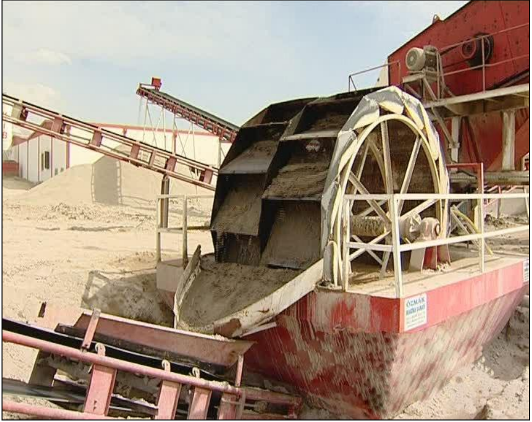
Şekil 2.9 Bims Yıkama Ünitesi
