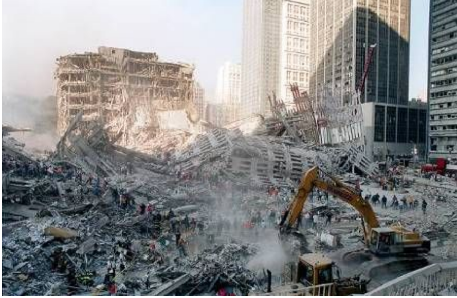
Şekil-4.29: Yıkıntının temizlenme süreci
