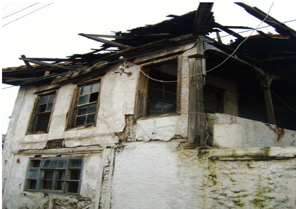
Fotoğraf 54 Saburhane Sokağında 44 Nolu Evin Durumu Foto: F. Üzeyiroğlu 2009
