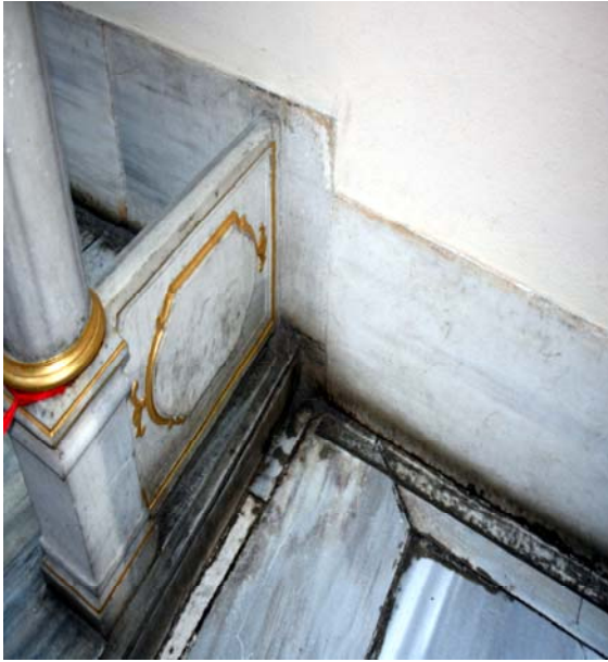
Şekil 4.51: Yer döşemesinde görülen su yolları
