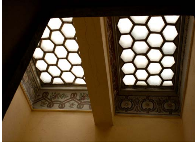
Şekil 4.24:Soğukluk Bölümü tavan aydınlatması
