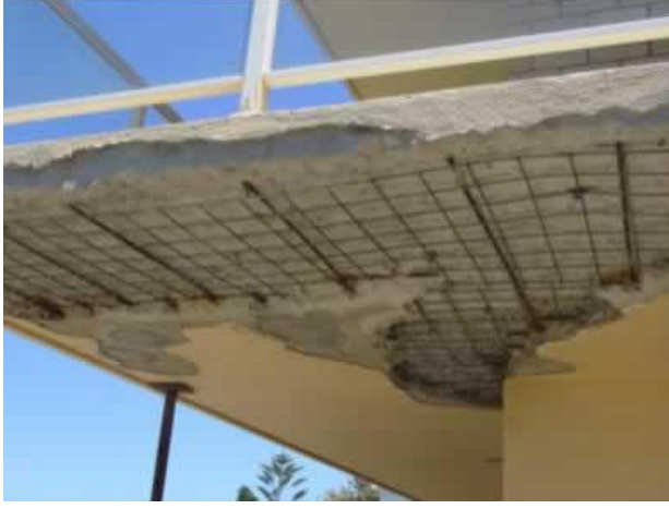
ekil 3.2 Donatı,da olu an korozyondan dolayı, pas payı, ve s,van,n dökülmesi
