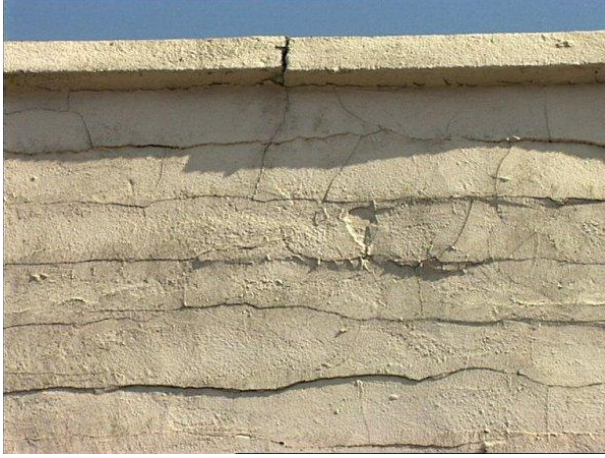
ekil 2.7 Sülfat Ata , oluşmasıyla s,vada oluşan çatlaklar
