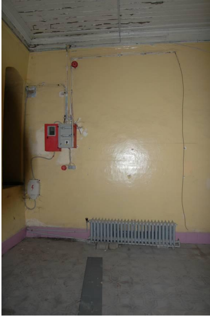
ekil 5.24 Zemin kat holü giri kap,s, yan duvar,ndaki elektrik saatleri.
