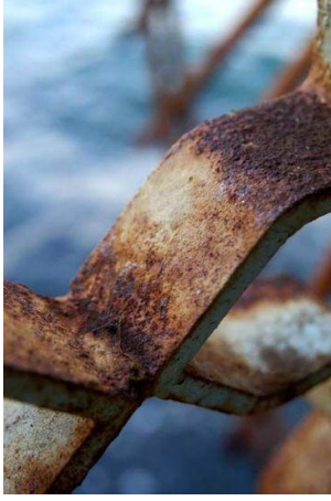
ekil 2.6 Demirin Korozyonu
