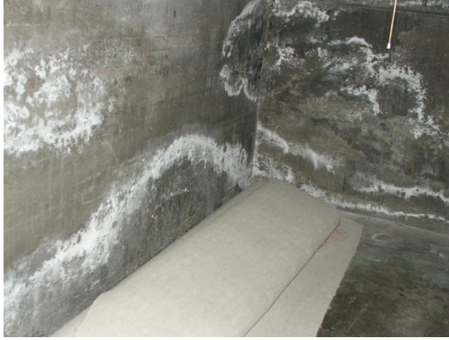
ekil 2.8 Duvar yüzeyinde çiçeklenme oluşumu.
