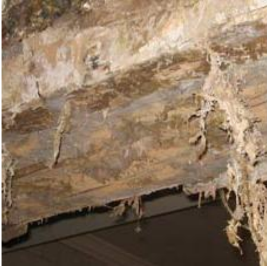
ekil 2.5 Ahapta küf oluşumu
