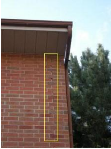
ekil 3.7 Çat,dan gelen suyun tu la duvar içrisine s,zmas,yla donma etkinden duvarda olu an bozulma
