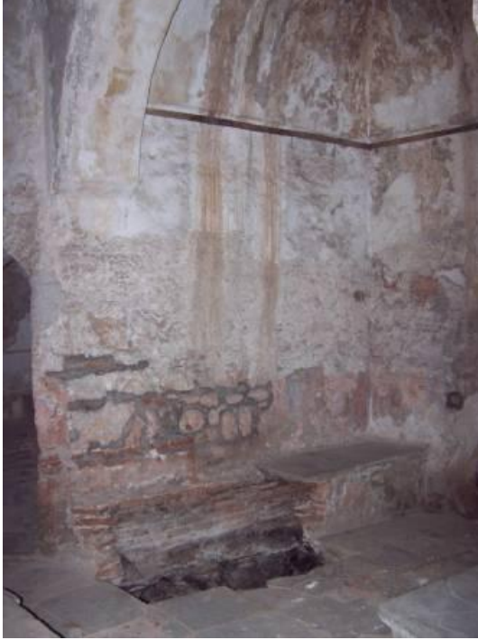
Resim 4.74 Sıcaklık bölümü girişi döşeme bozukluğu
