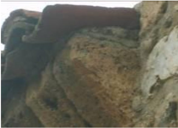
Resim 4.25 Doğu Cephesi – Silme detayı
