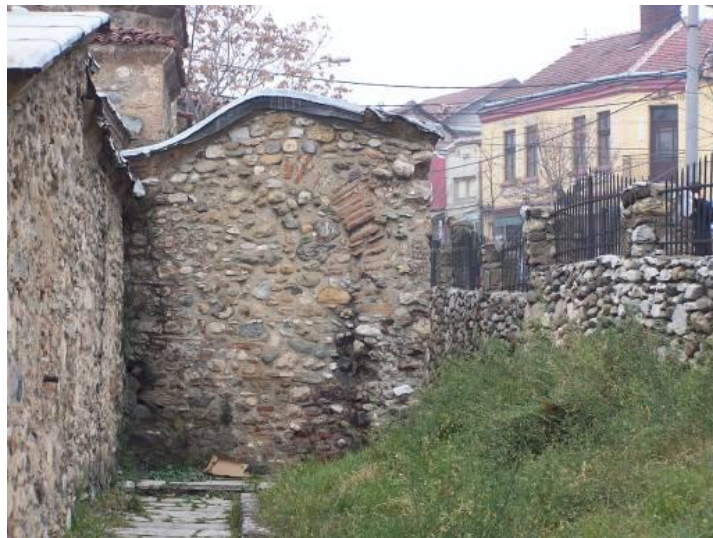
Resim 4.31 Güney Cephesi- Erkekler kısmı Ilıklık bölümünde bulunan tuvaletler duvarı
