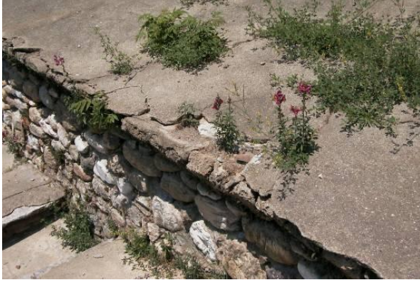
Resim 4.42 Çatı örtüsü – Bozulmuş kısımlar (Prizren – Anıtlar Koruma Enstitüsü'nden)
