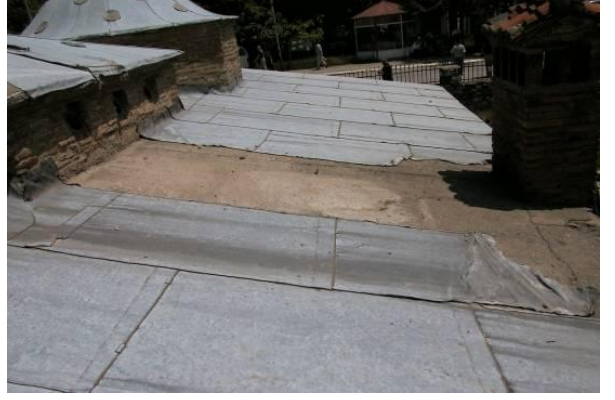
Resim 4.43 Çatı örtüsü - Bozulmuş kısımlar (Prizren – Anıtlar Koruma Enstitüsü'nden)
