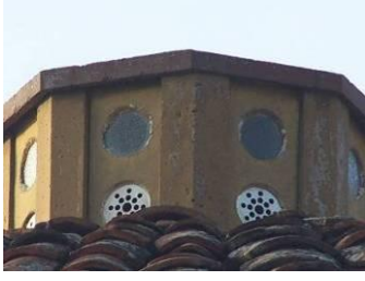
Resim 4.13 Kuzey Cephe – Soğukluklarda bulunan çatı feneri
