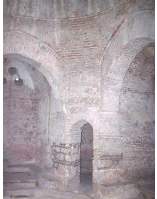
Resim 4.71 Erkekler kısmı Sıcaklık bölümü halvet geçidi
