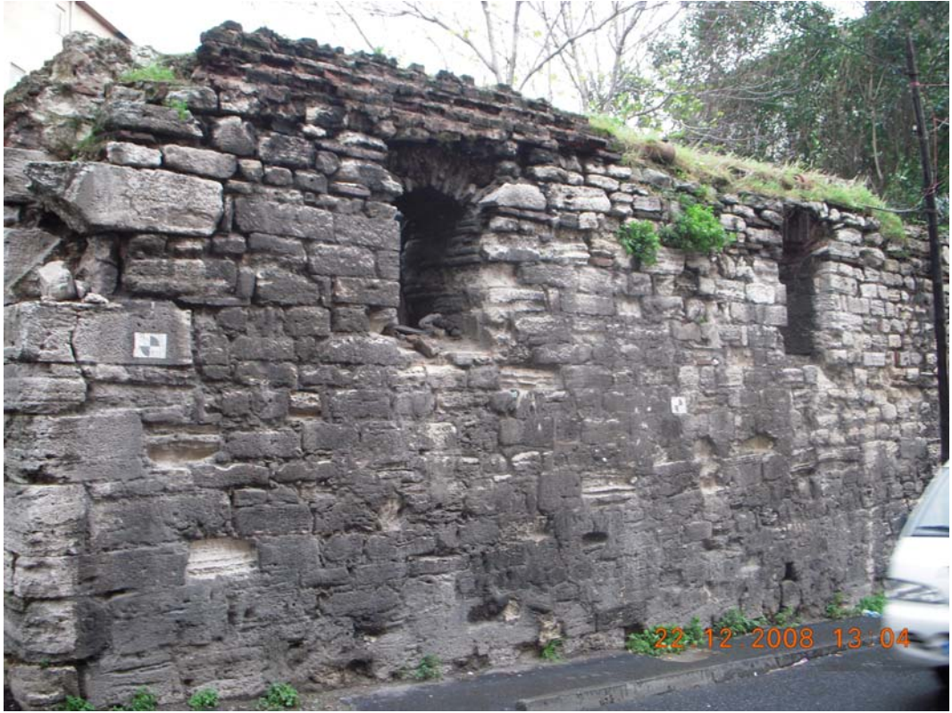
Foto 83 Süleymaniye Caddesi 1 parsel cephesinde bozulmalar
