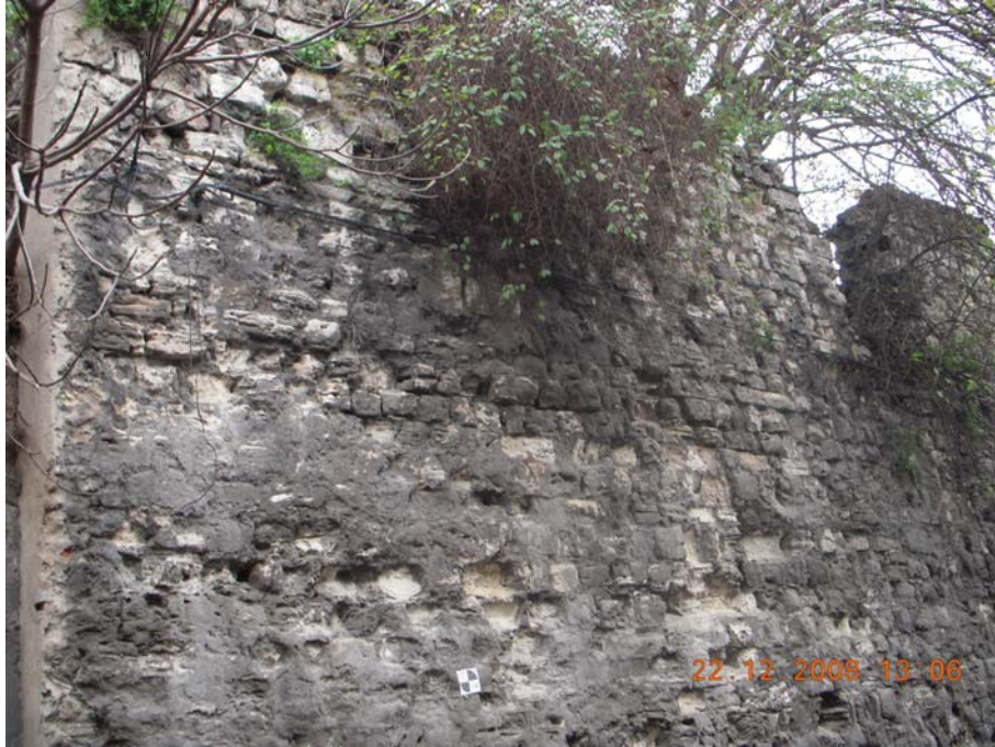
Foto 91 Süleymaniye Caddesi 7 parsel cephesinde bozulmalar
