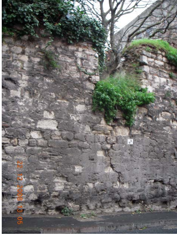
Foto 88 3 parsel cephesinde kararmalar, yapısal bozulma, bitkilenme
