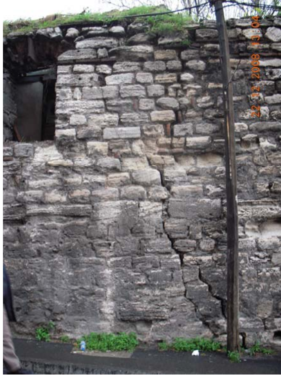
Foto 86 Taş duvar yapısında strüktürel bozulma
