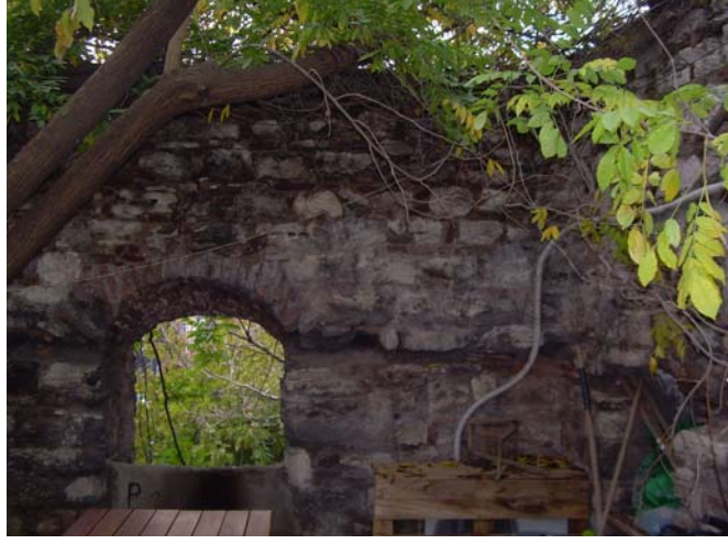
Foto 69 24 No'lu parsel üst kot pencere boşluğu
