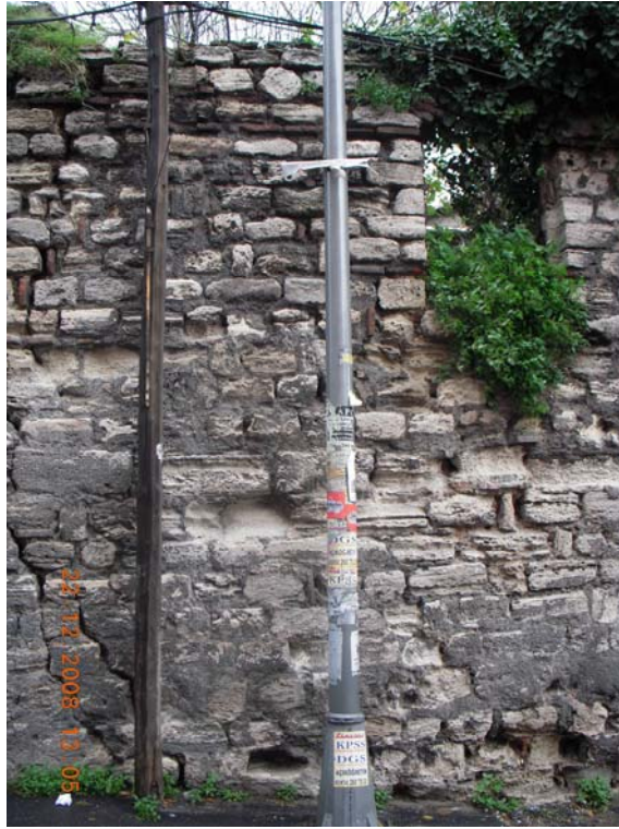
Foto 87 Duvar yüzeyinde deformasyonlar, kararmalar, bitkilenme
