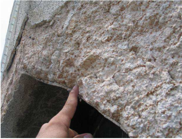
Şekil 78 Örnek 1. Minare şerefe çıkış kapısı üzeri sıva örneği
