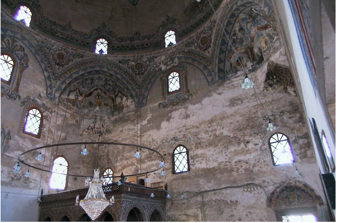
Şekil 59 Giriş Cephesindeki iç duvarlarda sıva dökülmesi
