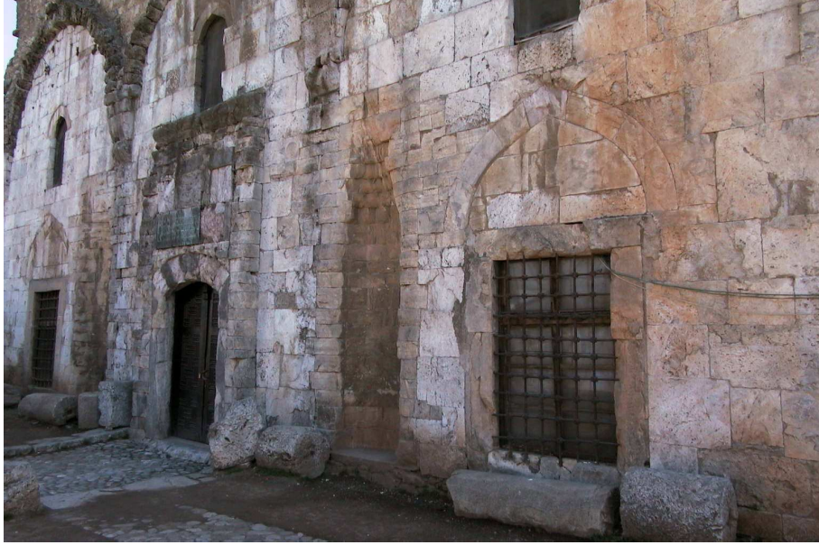
Şekil 60 Giriş Cephesinde meydana gelen taş malzeme kaybı
