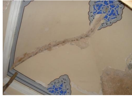
Resim 4.60. M04 mahalindeki tonozda çatlak (12)
