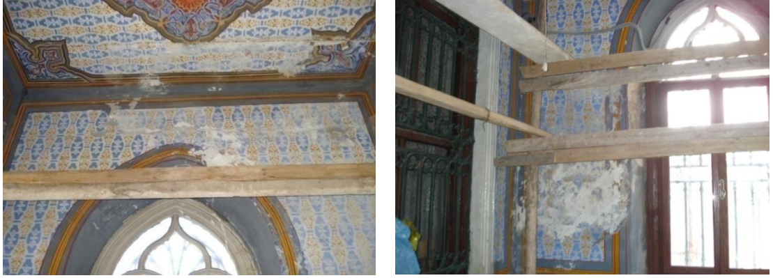
Resim 4.177-178. Rutubetlenmeden kaynaklanan boya dökülmesi
