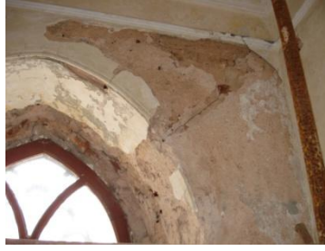
Resim 4.49. M03 mahali, duvarda çatlak (9)
