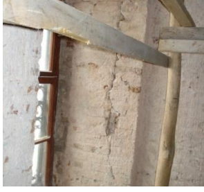
Resim 4.48. M06 mahali, pencere kemerinde çatlak (8)
