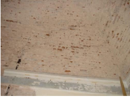
Resim 4.57. M09 mahalindeki tonozda çatlak (7)
