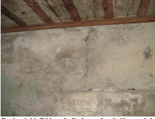
Resim 4.44. B11 mahali, duvarda görülen çatlak (1)
