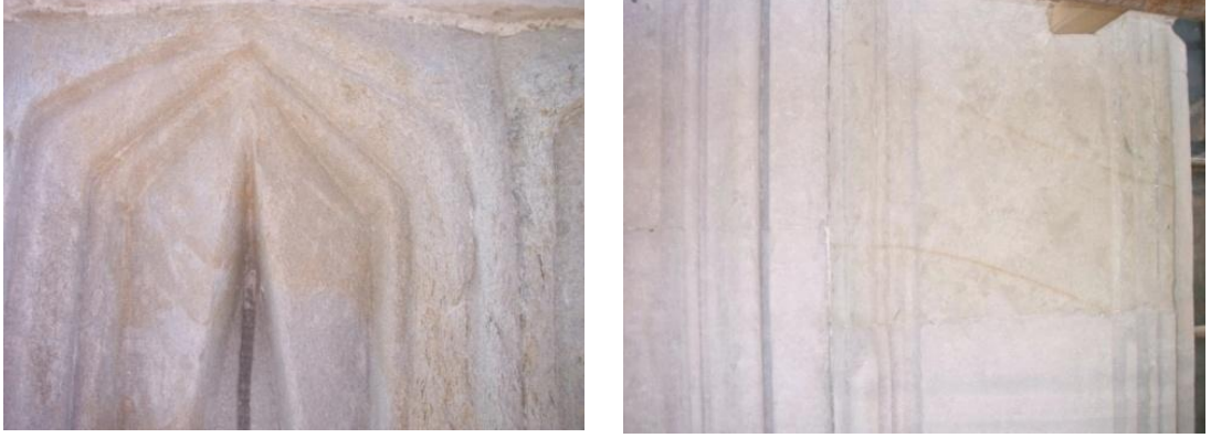
Resim 4.237-238. Sağlamlaştırma sonrasında taş yüzeydeki sararma
