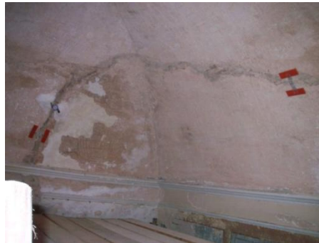
Resim 4.61. Tonoza yerleştirilen çatlakölçerler
