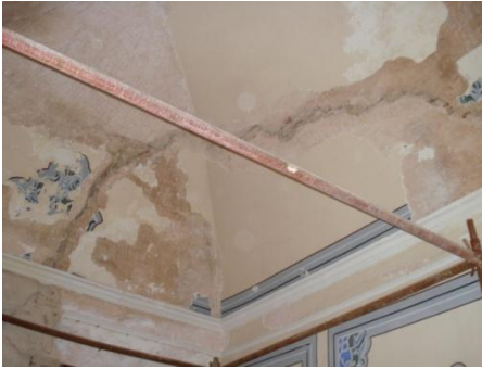
Resim 4.59. M01 mahalindeki tonozda çatlak (11)
