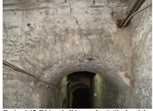
Resim 4.45. B06 mahali kemerde görülen çatlak (3)
