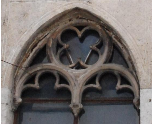
Resim 4.100. Boya tabakası temizlenmeden önce
