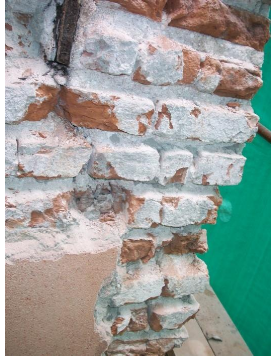
Resim 4.52. Dış cephe duvarında çatlak
