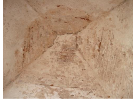
Resim 4.58. M02 mahalindeki tonozda çatlak (10)
