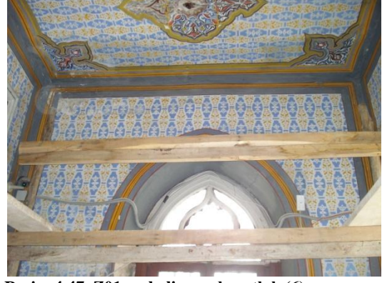
Resim 4.47. Z01 mahali, sıvada çatlak (6)
