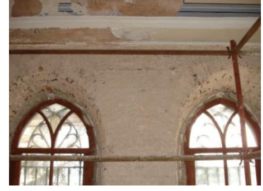
Resim 4.50. M04 mahali, duvarda çatlak (12)
