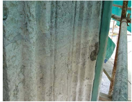
Resim 4.84. Taş yüzeylerde görülen portland çimento
