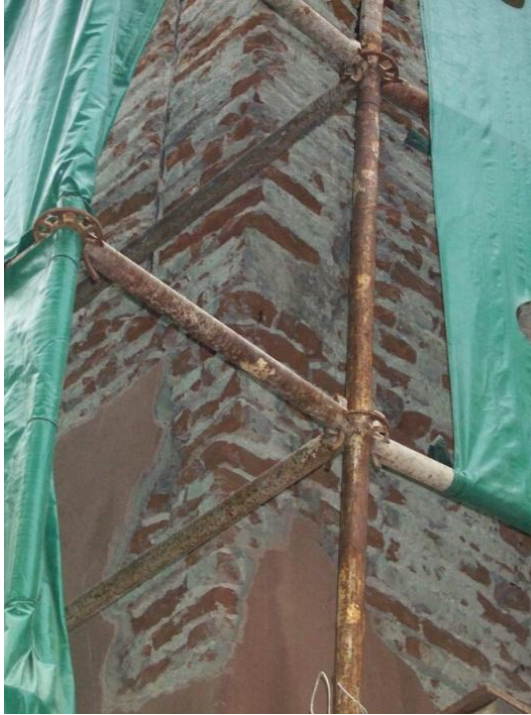
Resim 4.51. Dış cephe duvarında çatlak
