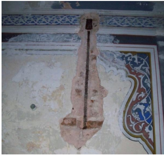
Resim 4.109. İç duvar yüzeyinde korozyona uğramış kılıç
