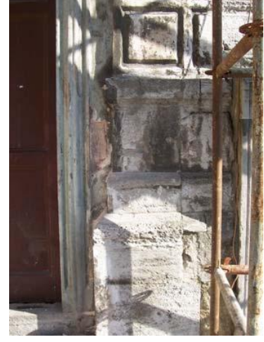
Resim 4.91. Özgün sıva kalıntısı bulunan yüzey
