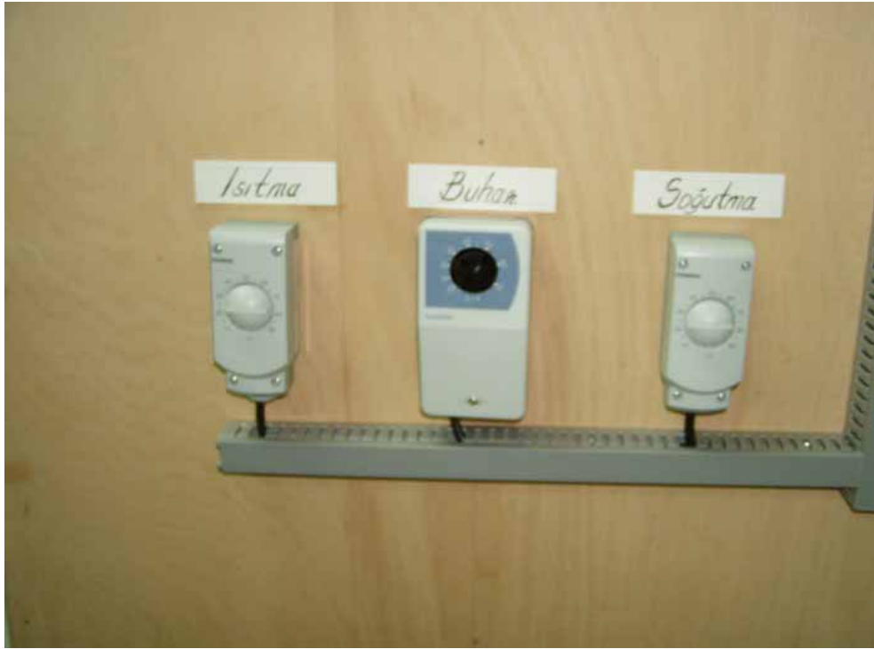
Resim 4-15-Isıtma, Buhar ve Soğutma Kontrol Birimleri
