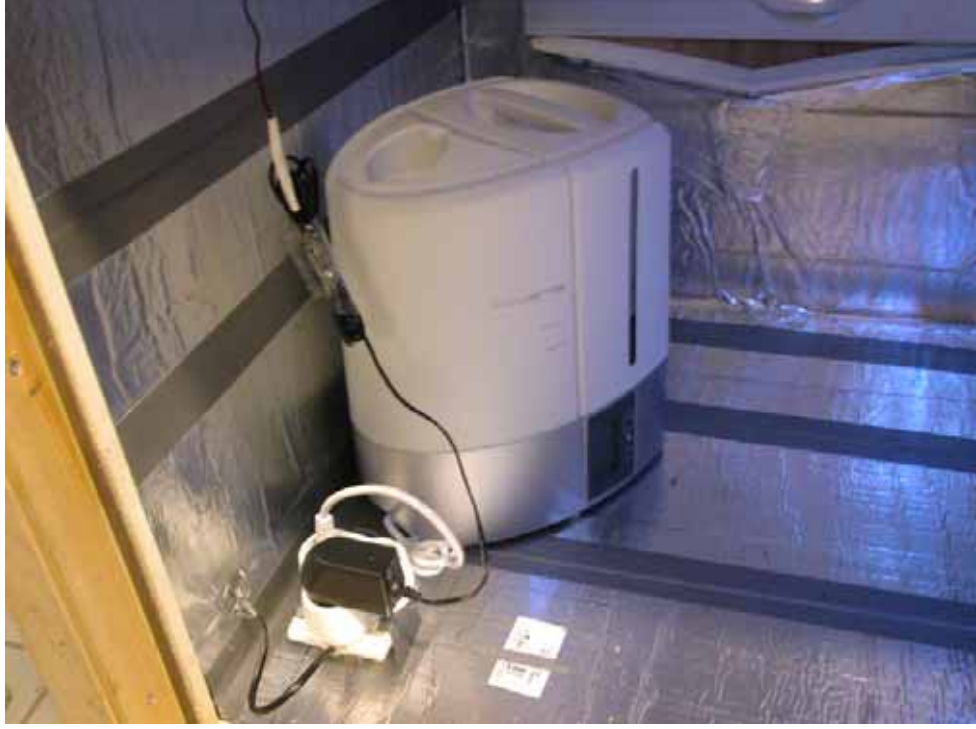
Resim 4-13-Buhar Jeneratörü ve Kabin İçi Elektrik Prizi
