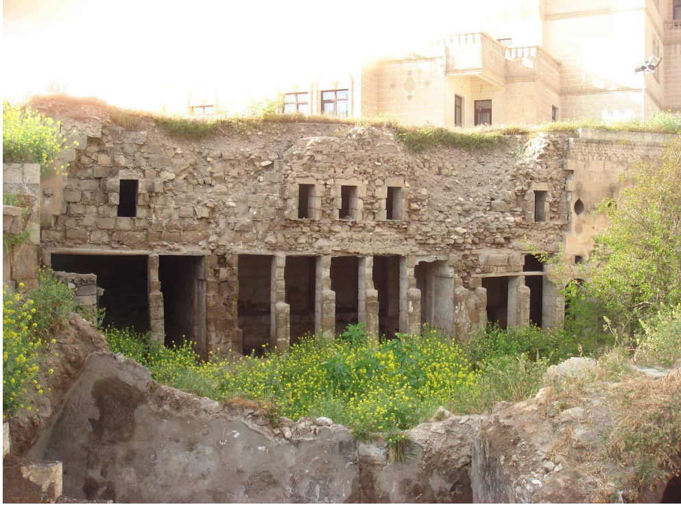
Resim 3.7. Dış yüzeyi yıkılmış sandık duvarlı bir konut 20
