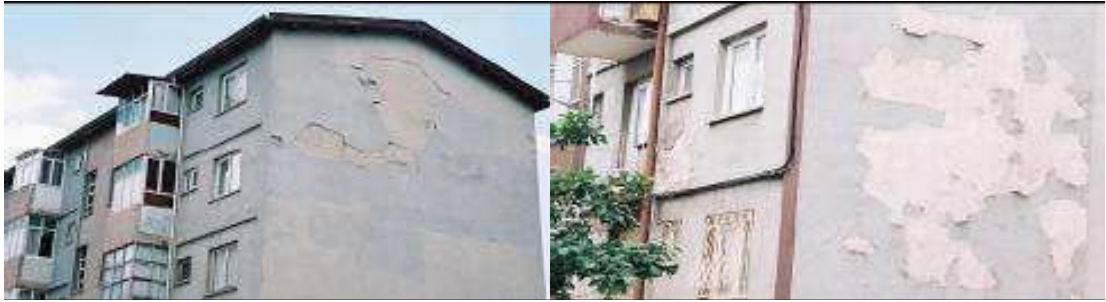
Resim 3.1. Nemli Havanın Yoğuşması Sonucunda Sıva ve Boyalarda Dökülmeler [22]
