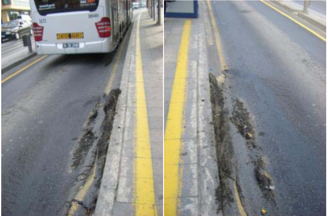
Şekil 3.6 Kabarıp yırtılarak platforma taşan asfalt yol ve izmaritler Haz. 2010
