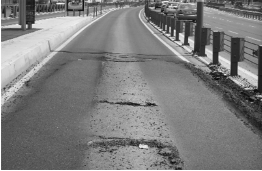
Şekil 3.7 Metrobüs hattında yıpranmış asfalt yol Ağustos 2009 [187]
