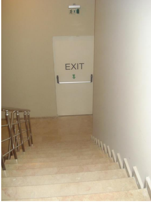
Şekil A.8. Yangın merdivenleri ve yangın kapısı (Sunar, 2010)
