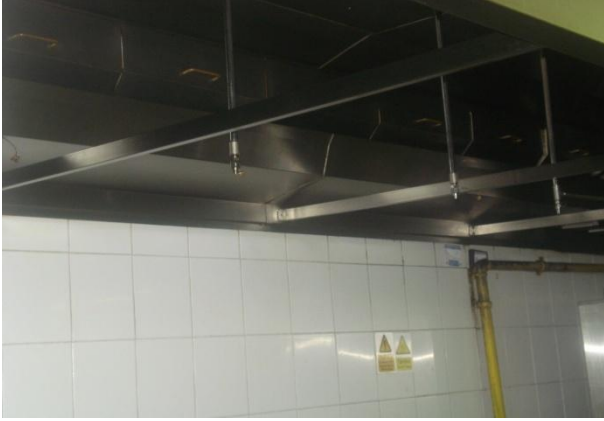
Şekil B.12. Mutfak davlumbazlarında kullanılan söndürme sistemi (nozullar) (Sunar, 2010)
