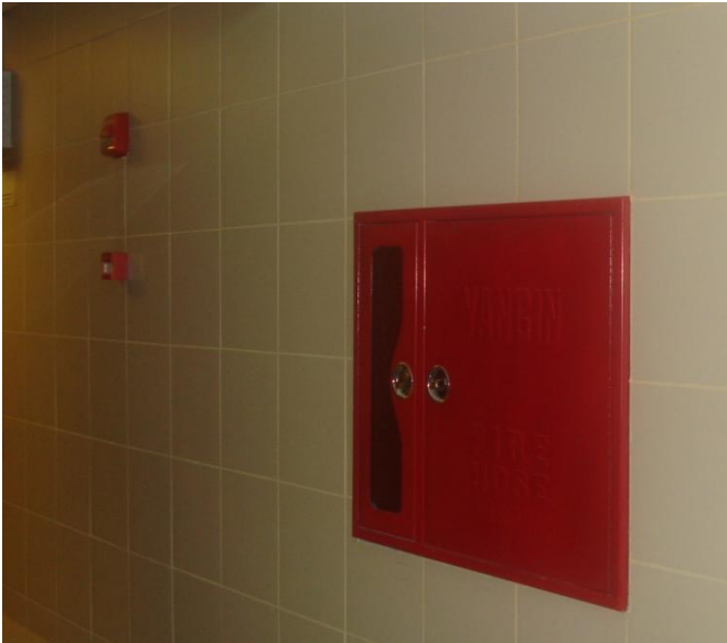
Şekil A.13. Mutfakta kullanılan ışıklı uyarı cihazı, yangın ihbar butonu ve yangın dolabı (Sunar, 2010)
