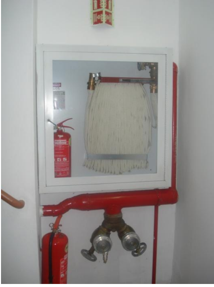
Şekil B.13. Yangın dolapları (Sunar, 2010)
