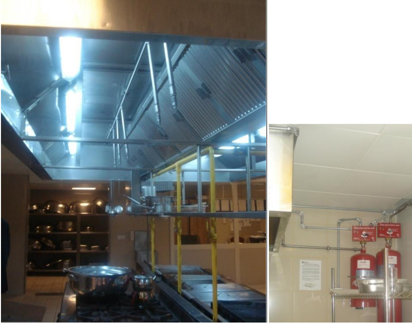
Şekil A.14. Davlumbaz söndürme sistemi (nozullar) ve bağlı olduğu köpüklü söndürme tüpleri (Sunar, 2010)
