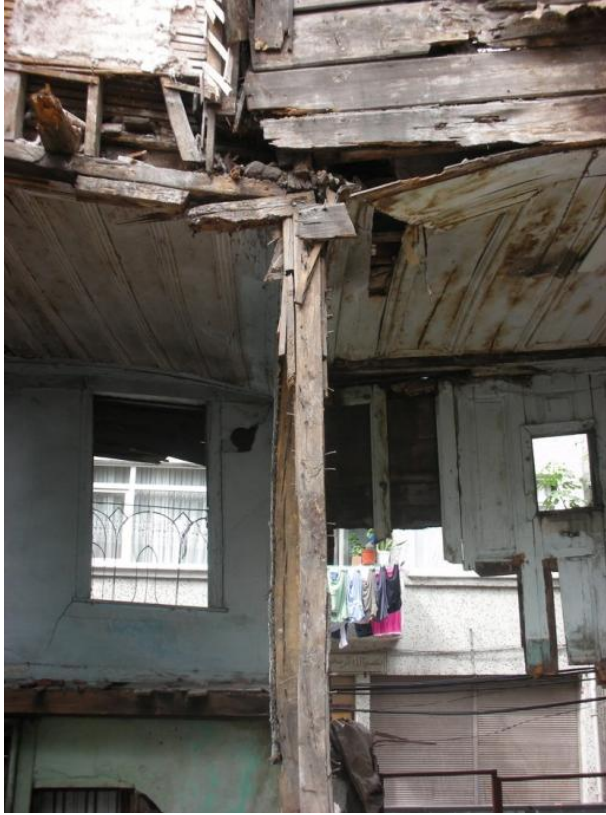
Resim A. 13 Çürümeye bağlı taşıma gücü azamış bir dikme ve kiriş bağlantısı (Fotograf: Dışkaya)
