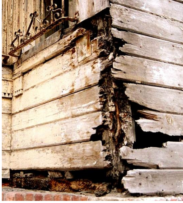
Resim A.7 Kâgir temele oturan taban kirişi ve dikmelerde çürümeye bağlı kopmalar(Fotograf: Dışkaya)
