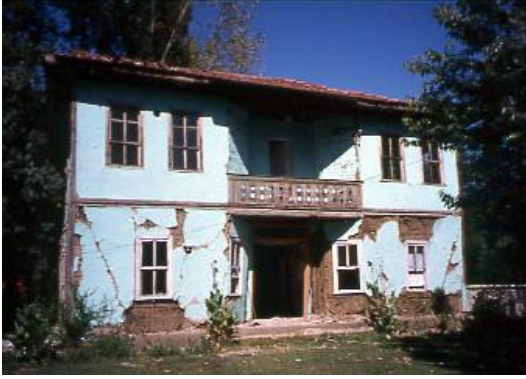
Resim 3.2 Düzce'de 12 Kasım zarar görmüş hıms sistem yapı (Kaynak: Aşkun, 1999)
