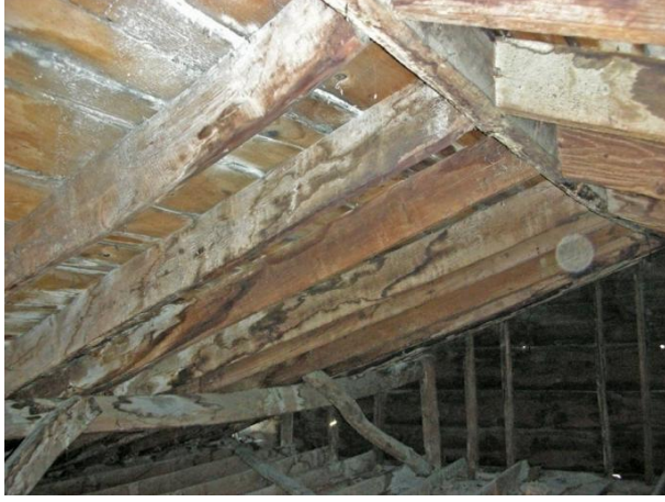
Resim A.4 Çatı kiriş ve aşıklarında nem ve çürümeye bağlı güç kaybı (Fotograf: Dışkaya)
