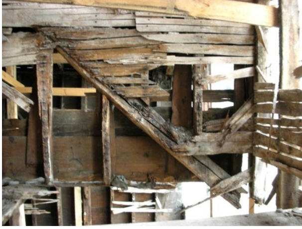
Resim A.10 Yapı iç bağdadi duvarlarında çürümeye bağlı ara dikme, payanda ve bağdadi çıtalarındaki kopma ve parçalanmalar (Fotograf: Dışkaya)
