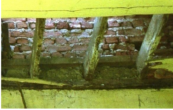
Resim A.15 Döşeme kirişlerinin kârgir duvar birleşimlerinde çürüme etkisi (Fotograf: Dışkaya)
