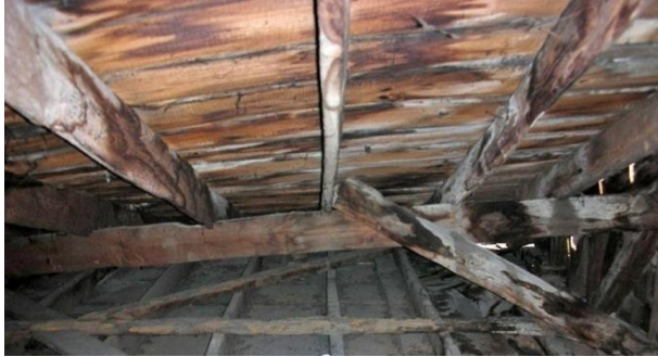
Resim A.6 Çatı kiriş ve aşıklarında rutubete bağlı kahverengi çürük ve taşıyıcı sistemde güç kaybı (Fotograf: Dışkaya)
