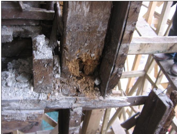
Resim A.11 Duvar içi dikme tabanında rutubete bağlı çürüme (Fotograf: Dışkaya)
