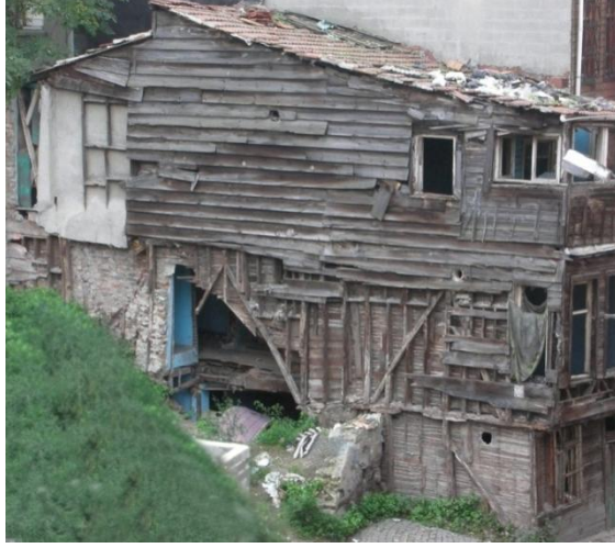
Resim A.17 Dikme ve payandaları çürümüş ve kopmuş bir yapı (Fotograf: Dışkaya)
