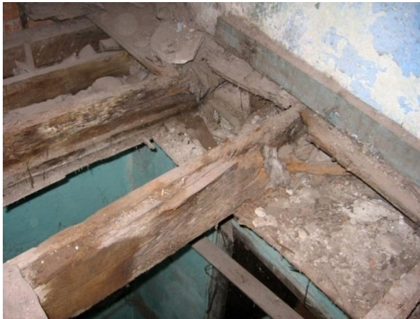
Resim A.16 Duvar çıkmasına oturan döşeme kirişlerinde rutubete bağlı çürüme etkisi (Fotograf: Dışkaya)
