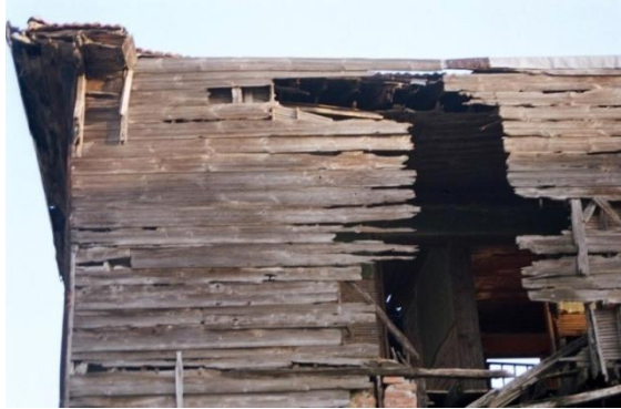
Resim A.19 Saçak altı çürümeye bağlı taşıyıcı sistem eksilmesi detayı (Fotograf: Dışkaya)
