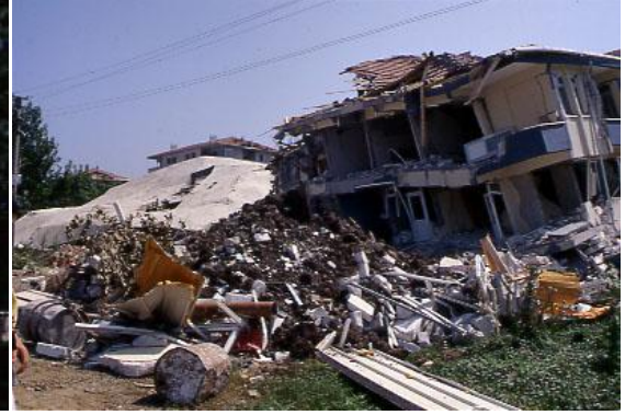
Resim 3.3 Düzce'de 12 Kasım depreminde yıkılmış betonarme bir yapı (Kaynak: Aşkun, 1999)
