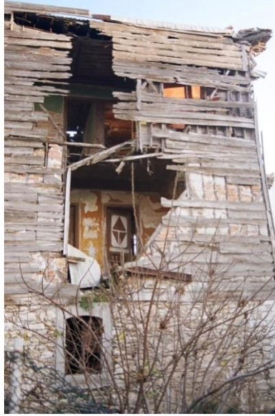
Resim A.18 Saçak altı ve taş temel üzerindeki taşıyıcıları çürümüş ve kopmuş bir yapı (Fotograf: Dışkaya)
