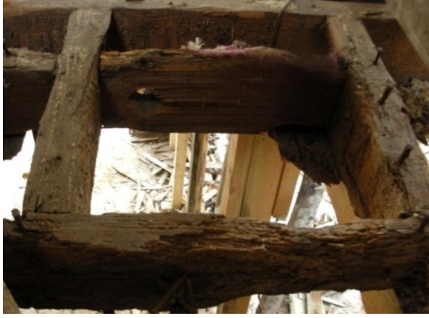
Resim A.14 Döşeme kirişlerinde rutubet ve böceklenme etkisi ile çürüme ve kesit kaybı (Fotograf: Dışkaya)
