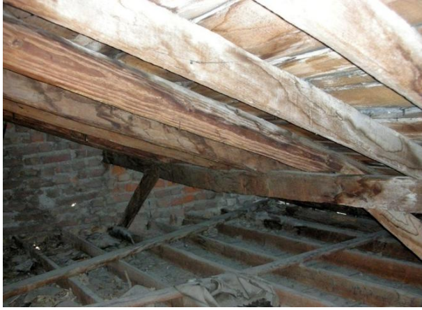
Resim A.5 Çatı kiriş ve aşıklarında neme bağlı güç kaybı (Fotograf: Dışkaya)
