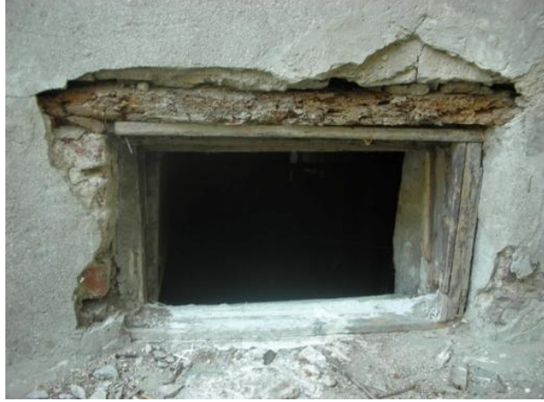
Resim A.1 Nem ve böceklenmeye bağlı olarak çürümüş bir kârgir duvar pencere hatılı (Fotograf: Dışkaya)
