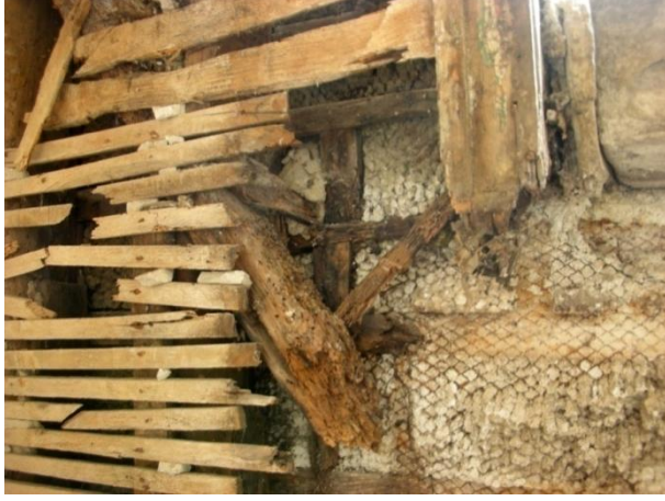
Resim A.9 Yapı iç bağdadi duvarlarında çürümeye bağlı dikme, payanda ve bağdadi çıtalarındaki kopma ve parçalanmalar (Fotograf: Dışkaya)
