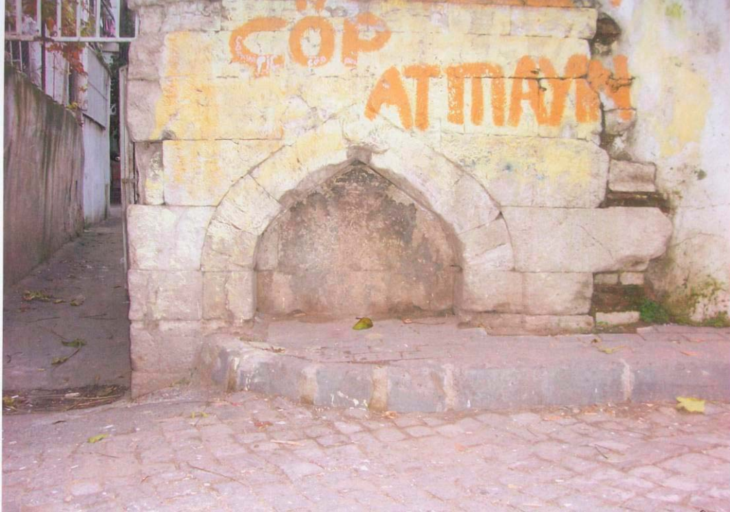
Foto C.12 Cerrahbaşı İshak Kazgani Sadi Çeşmesi Ön Cephesi
