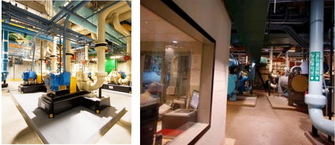
Şekil 4.58. Mekanik soğutma (chiller) odaları 198
