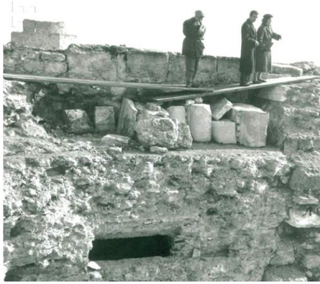
4.13 Cahide Tamer, Yedikule restorasyonu (1959-1960) sırasında şantiyede, Kaynak: C. Tamer arşivi, Sanal Mimarlık Müzesi.
