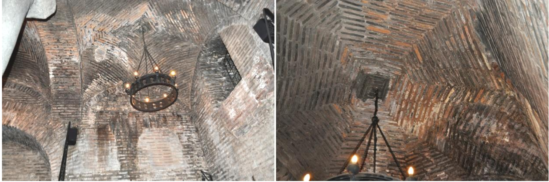
Şekil 5.16. Üst örtüyü oluşturan tuğla malzeme yüzeyinde siyah patina oluşumu
