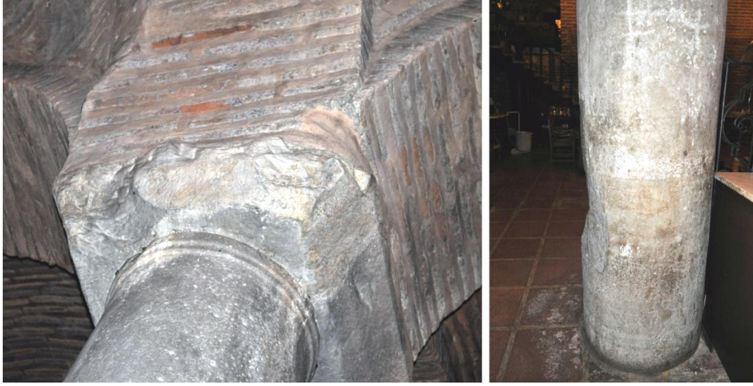
Şekil 5.14. Mermer malzemede kesit kaybına neden olan kopmalar
