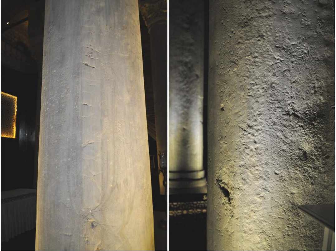
Şekil 5.19. Mermer sütunların yüzeyinde çatlaklar ve irili ufaklı parça kayıpları
