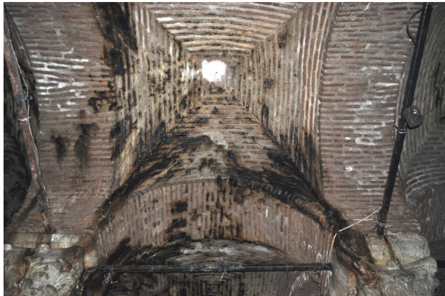
Şekil 5.29. Tuğla malzeme yüzeyinde oluşan çiçeklenme ve siyah patina
