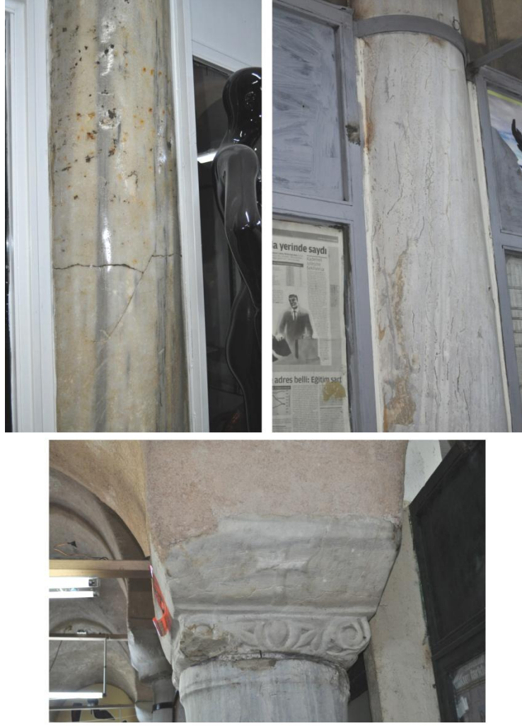
Şekil 5.10. Mermer malzeme de kopmalar, derin ve kılcal çatlaklar
