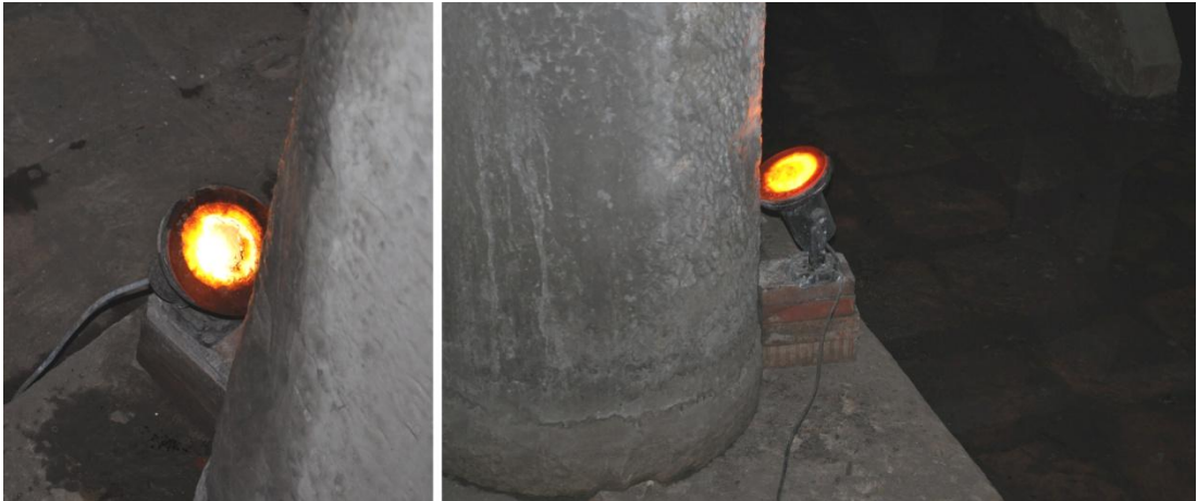
Şekil 5.30. Taş parçaları üzerine gelişigüzel yerleştirilmiş, yetersiz ve kirlenmiş filtreli par tipi halojen ampullü aydınlatma elemanları.
