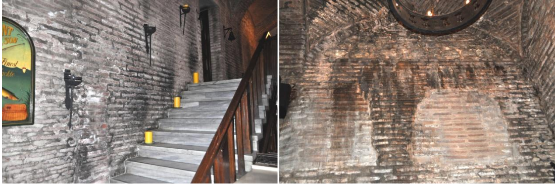
Şekil 5.15. Tuğladan örülmüş duvar yüzeyinde siyah patina oluşumu
