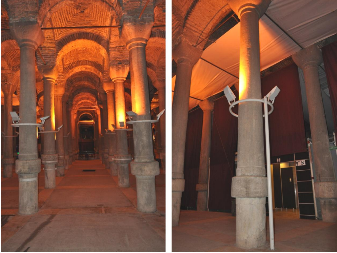
Şekil 5.5. ve 5.6. Sarnıçın strüktürel yapısına uygun yapay aydınlatma. Kolonlara zarar vermeyecek şekilde tasarlanmış aydınlatma elemanı.
