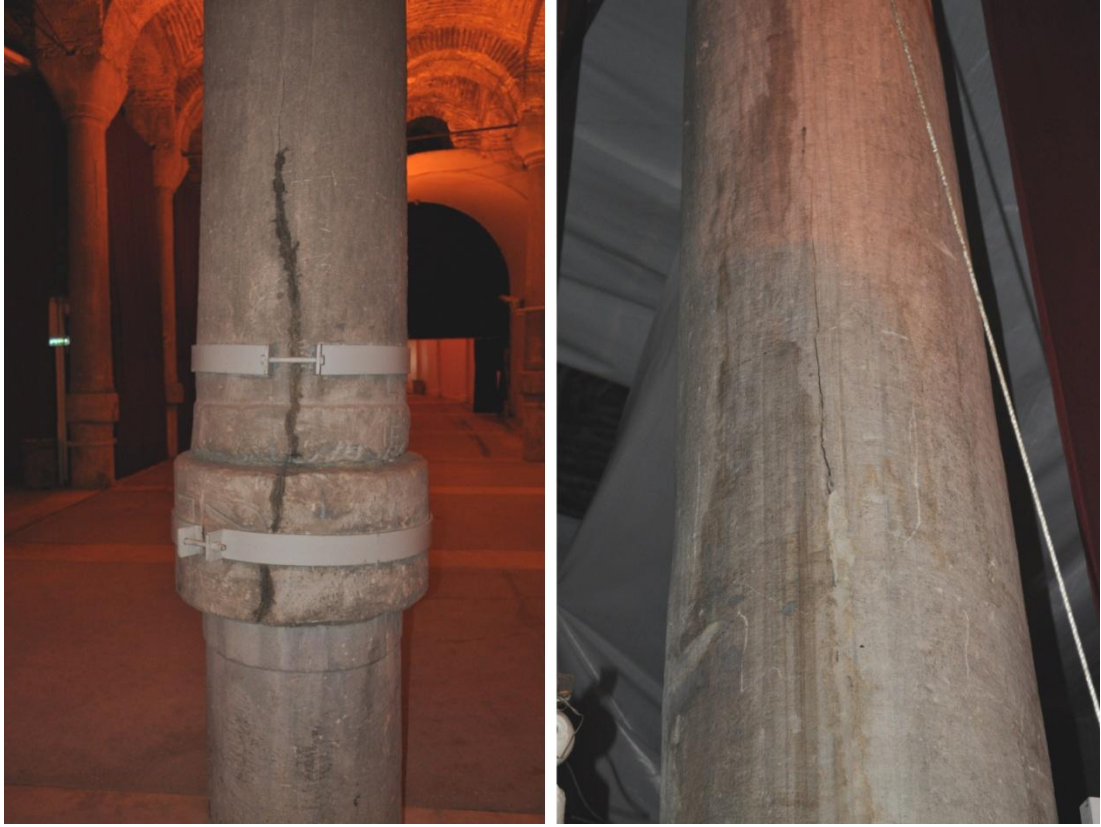
Şekil 5.4. Kolonlarda diferansiyel kuvvetler etkisiyle meydana gelen çatlaklar
