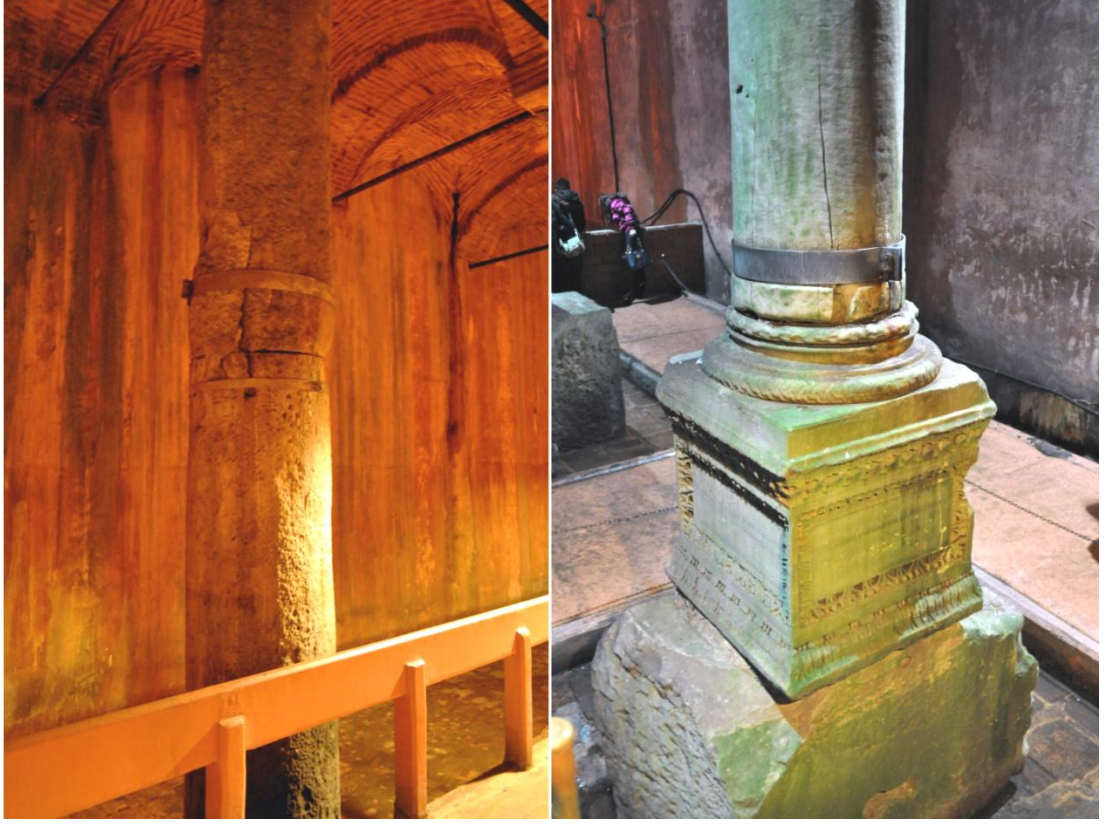
Şekil 5.25. Sütunlardaki derin çatlak ve deformasyonlar
