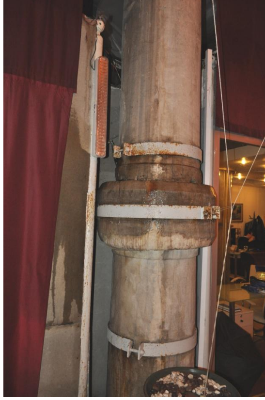
Şekil 5.7. Üst örtüden sızan suyun yapı elemanına verdiği zarar.
