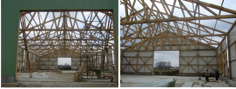
Resim 3.5.3 Üretim tesisi konstrüksiyonu, arşiv 2006.
