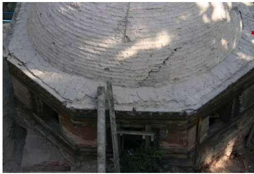
Resim 3.49. Merkezî kubbe üzerindeki çatlaklardan biri
