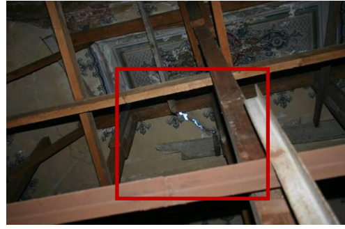
Resim 3.52. Kuzeybatı tonozundaki çatlağa içeriden bakış
