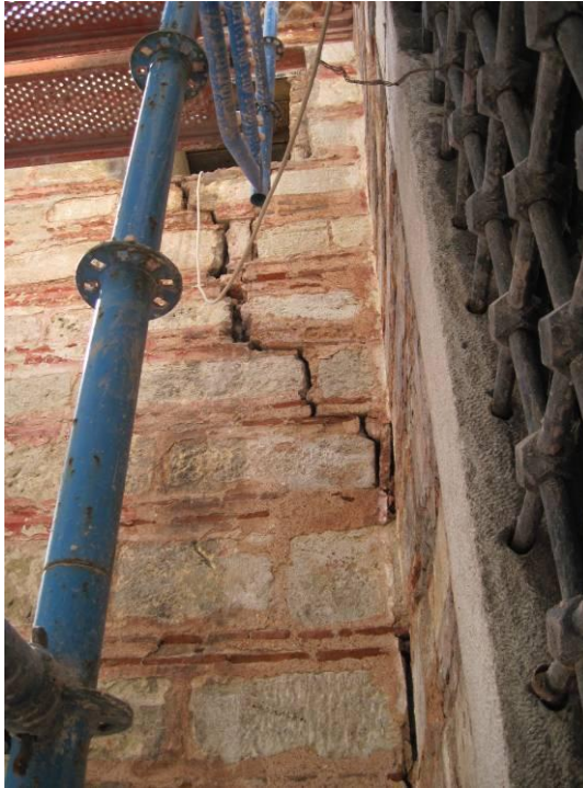
Resim 3.62. Almaşık örgülü cephe duvarlarında çatlak
