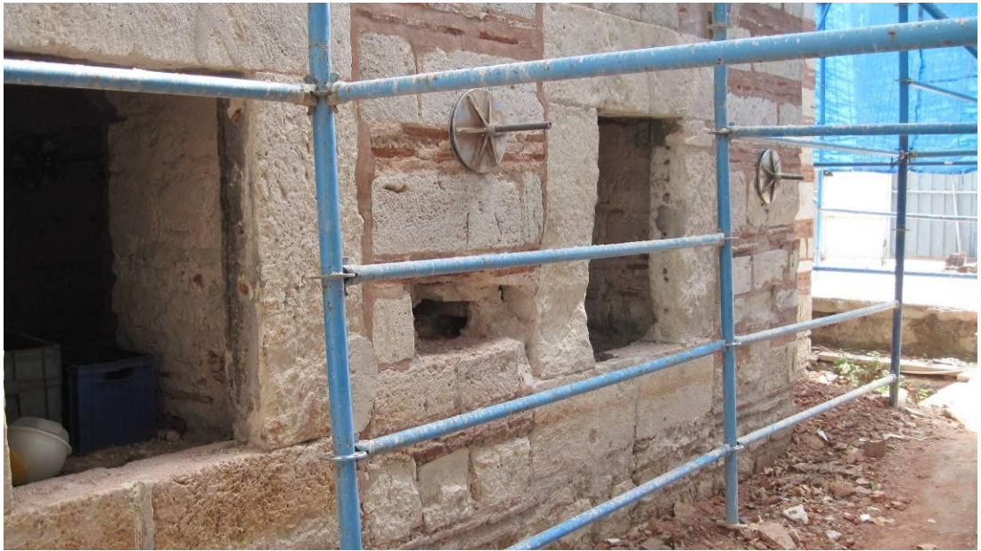
Resim 3.97. Paslanmaz çelik gergilerin duvardan çıktığı noktalarda paslanmaz çelik flanşlar
