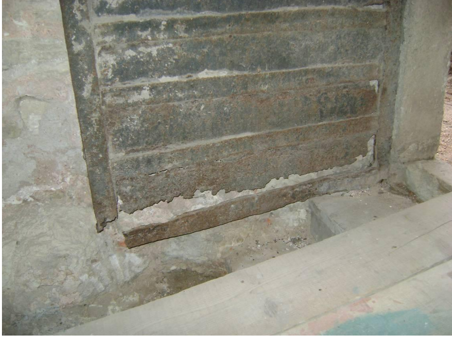
Resim 3.85. Bodrum kat giriş kapısı altında çürüme
