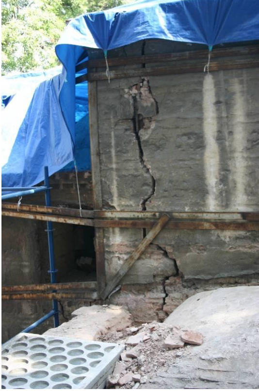
Resim 3.32. Kuzeybatı duvarında meydana gelen çatlak
