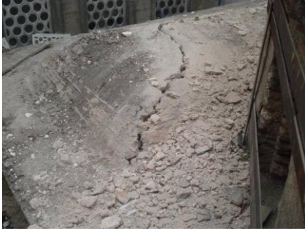
Resim 3.51. Kuzeybatı tonozunda meydana gelen çatlak
