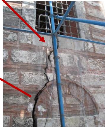
Resim 3.69. Pencere sövelerinde çatlak
