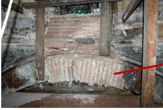
Resim 3.37. Kuzeybatı kemerinde çökmüş olan orta kısım
