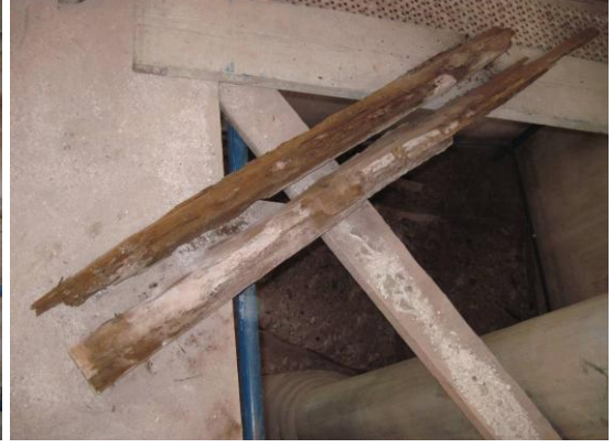
Resim 3.22. Köşe kubbe pencere altı hizasından çıkan çürümüş ahşap hatıllar
