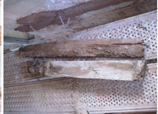
Resim 3.31. Pencere üstlerinden çıkarılan çürümüş ahşap hatıllar
