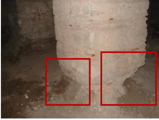
Resim 3.28. Bodrum kat paye altlarındaki hasarlı ahşap hatıl yuvaları
