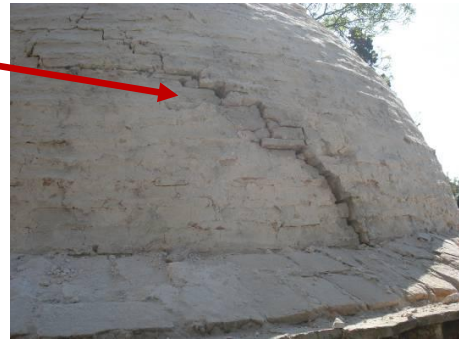
Resim 3.50. Merkezî kubbe üzerinde çatlaklardan biri
