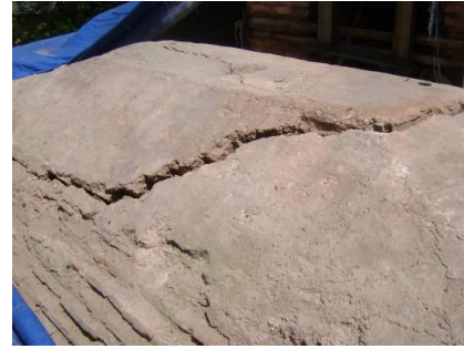
Resim 3.54. Kuzeybatı tonozundaki meydana gelen katmanlaşma
