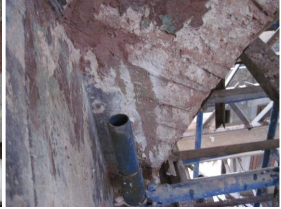
Resim 3.112. Kemerin sütuna oturduğu noktadaki çatlağın kendi özgün harcıyla onarımı
