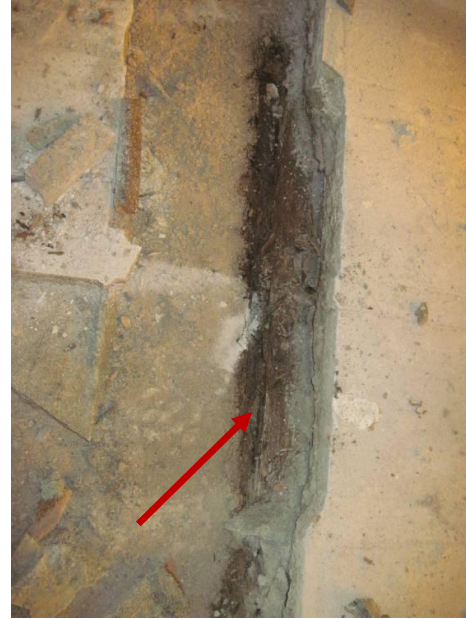
Resim 3.27. Döşeme altında çürümüş ahşap hatıl detayı
