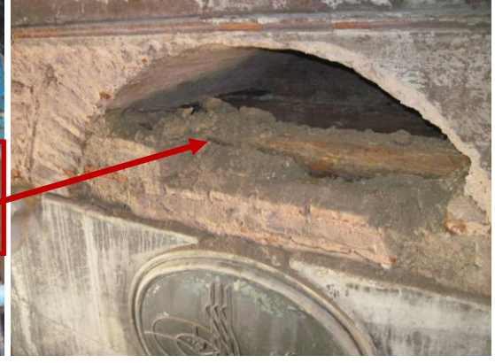
Resim 3.25. Çürümüş ahşap hatıl detayı
