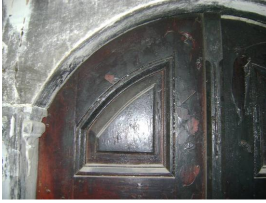
Resim 3.75. Giriş kapısının yanmış bölümü
