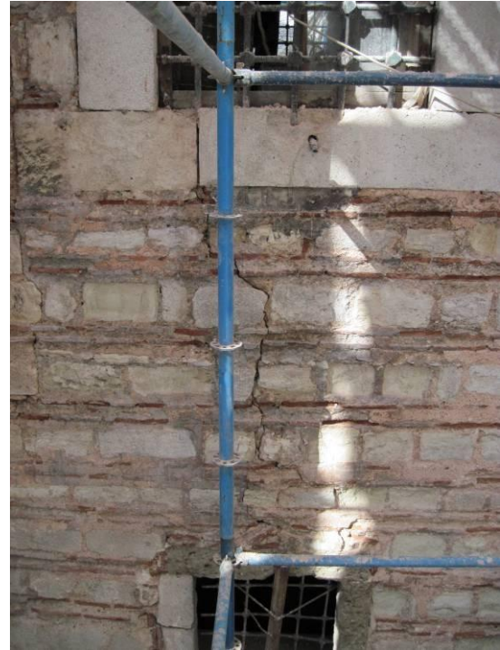
Resim 3.63. Almaşık örgülü cephe duvarlarında çatlak
