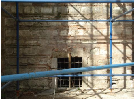
Resim 3.158. BKP-1 no.lu pencerenin (Şekil A.18) taş sövesi ve duvarlardaki hasarlı taşlar onarımdan
