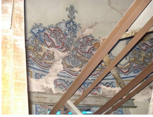
Resim 3.46. Merkezî kubbede içeriden gözlemlenen çatlaklar
