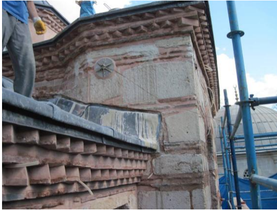
Resim 3.90. Dış duvarda gergiyi bağlayan flanş
