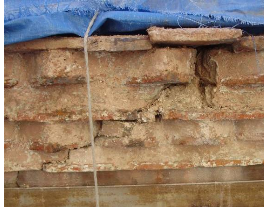
Resim 3.65. Kirpi saçakta çatlaklar
