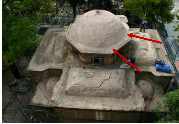
Resim 3.48. Kütüphane üst örtüsünde çatlaklar
