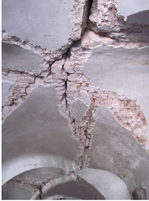
Resim 3. 36. Bodrum kat tavanlarında devam eden çatlaklar
