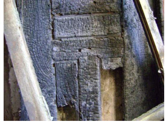
Resim 3.76. Yanmış ahşap kepenlerde kömürleşme
