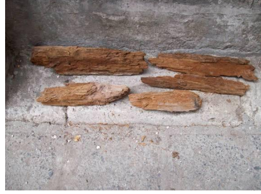
Resim 3.59. Yapısal özelliklerini kaybeden çürümüş küçük parçalı ahşap hatıllar
