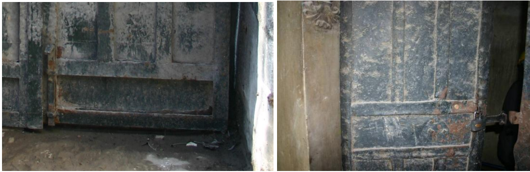
Resim 3.83. Hazire duvarı demir kapısı altında çürüme
