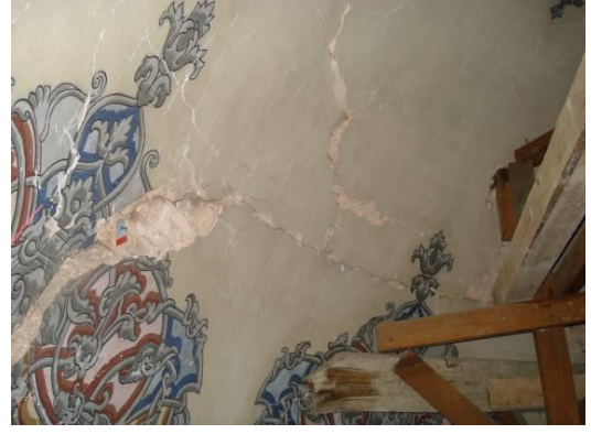
Resim 3.47. Merkezî kubbede içeriden gözlemlenen çatlaklar
