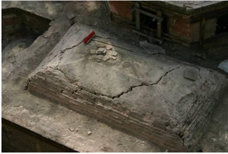
Resim 3.53. Kuzeybatı tonozunda meydana gelen çatlak
