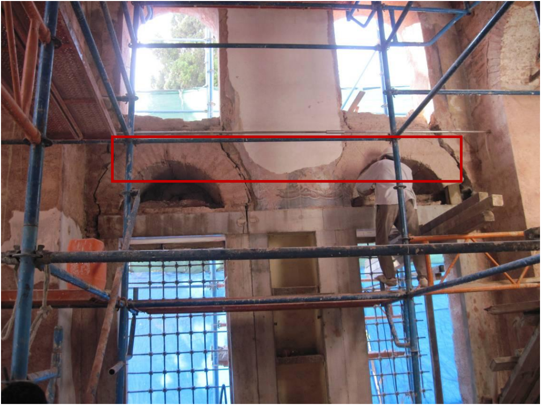
Resim 3.23. Pencere üstleri kemer aynası boşluklarındaki çürümüş ahşap hatıllar
