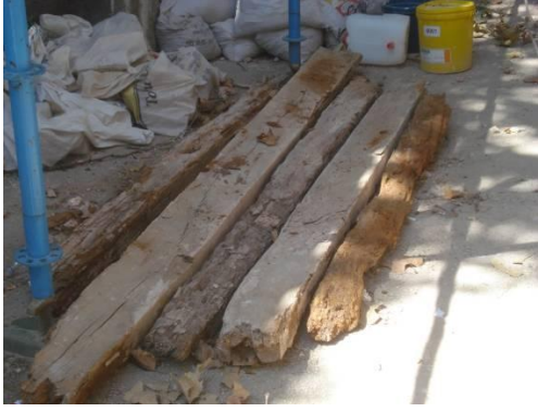
Resim 3.58. Yapısal özelliklerini kaybeden çürümüş ahşap hatıllar
