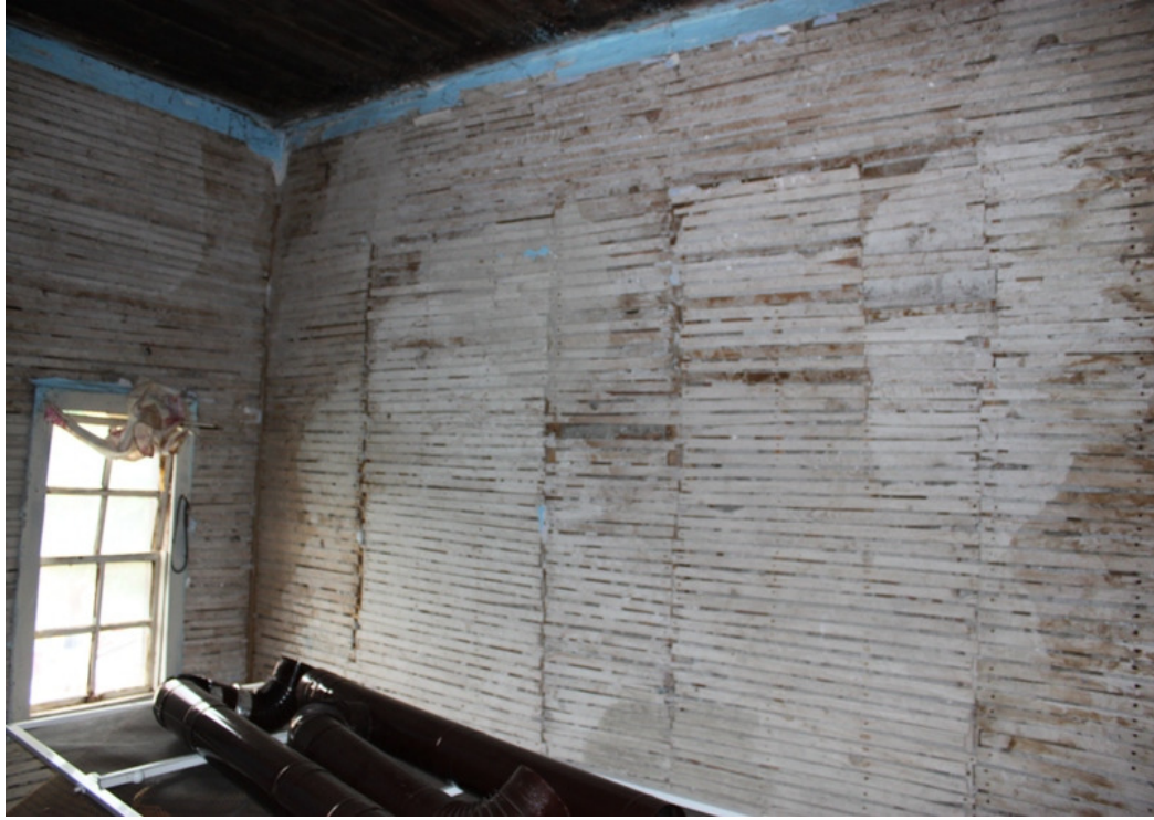
Şekil 3.47. Odalarda iç sıvaların dökülmüş durumu
