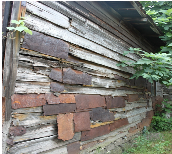
Şekil 3.31. Mustafa Bakan Evi'nin yan cephelerinde yalı baskısı kaplama ve yapılan onarımların izleri
