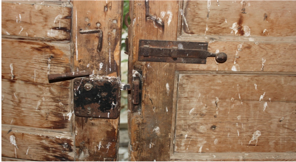
Şekil 3.123. Halil Uçkıran Evi giriş kapısının kilit sistemi
