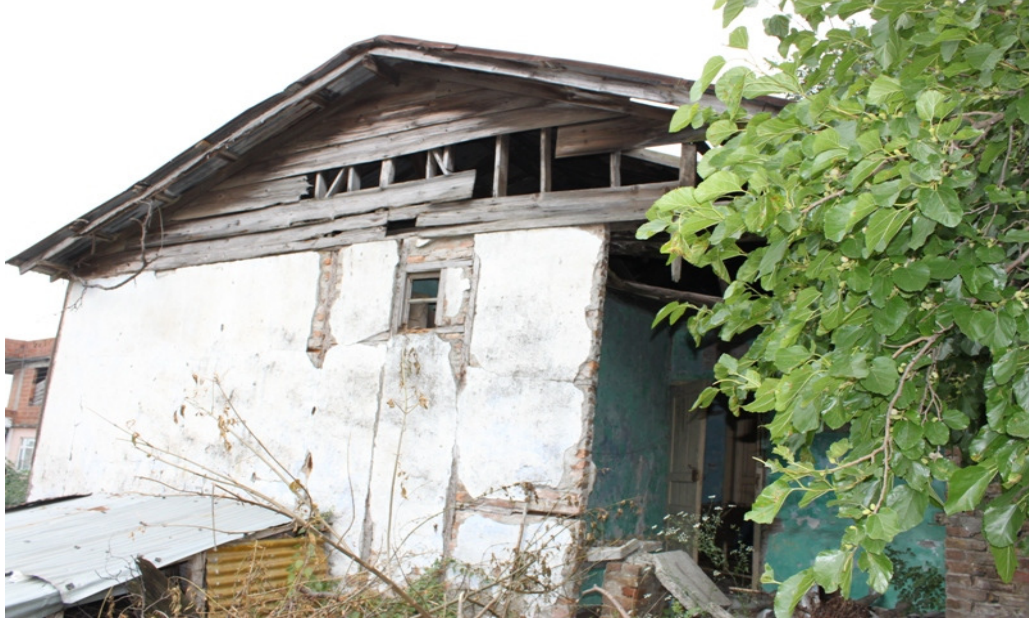
Şekil 3.70. Bir kısmı onarılarak kurtarılmış, bir kısmı ise yıkılmış olan yan cephe
