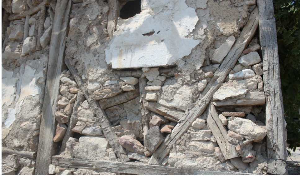
Şekil 3.181. Yan cephe duvarlarında yer alan arası gelişigüzel doldurulmuş karkas sistem çamur sıva ve en üstte kireç badanası
