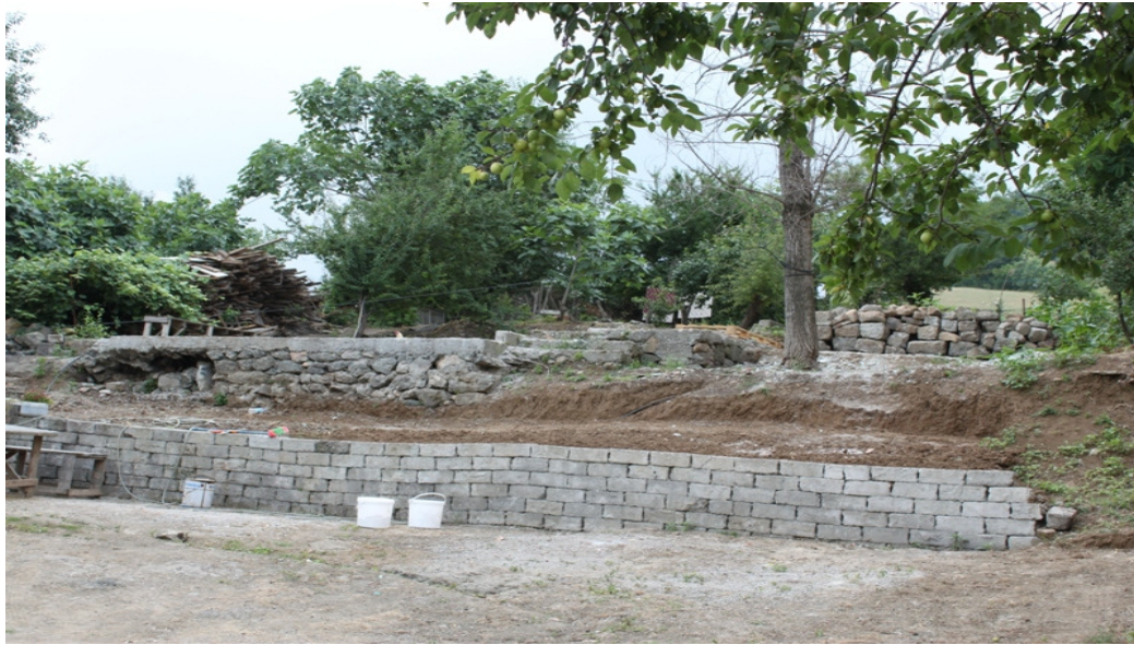
Şekil 3.80. Arazi çalışmamız sırasında rastladığımız yeni yıkılmış ve inşaat malzemesi tasnif edilmiş olan mübadil evi
