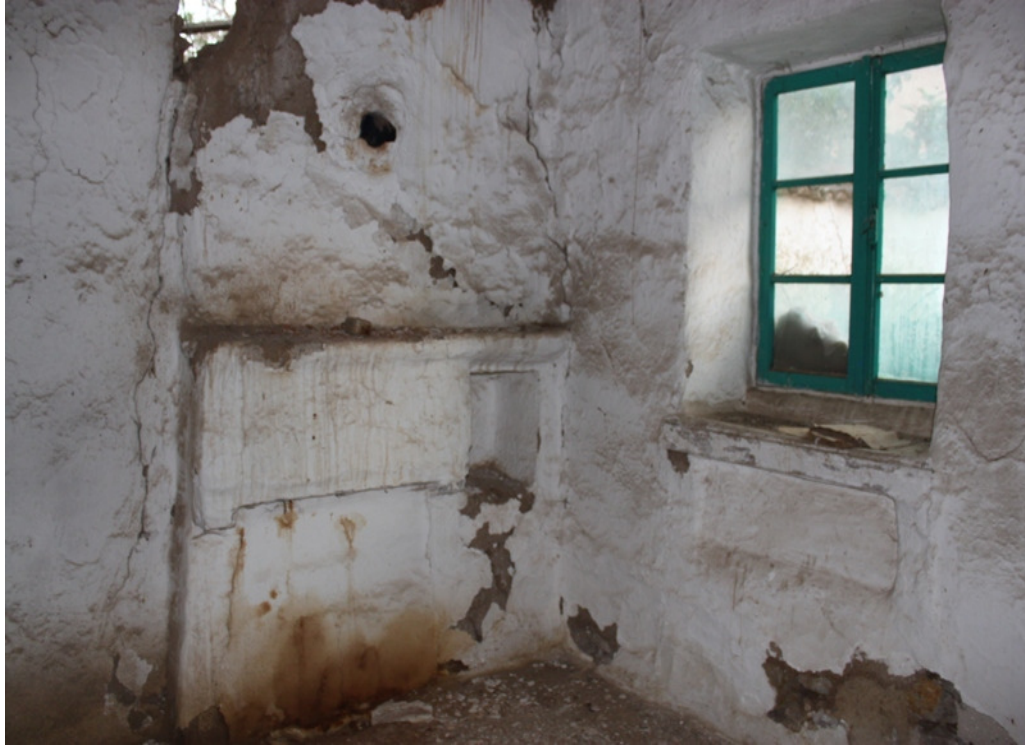
Şekil 3.127. Mutfak bölümünde kapatılan ocak ve çift kanatlı bölümlenmiş pencere
