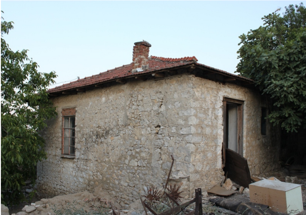
Şekil 3.117. Halil Uçkıran Evi'nde özgün olmayan giriş ve yan cephe
