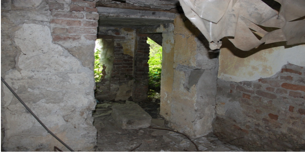
Şekil 3.25. Bodrum katta, ahır bölümüne girişi sağlayan kapı (ahır mekânının yan duvarları yıkılmış durumdadır)
