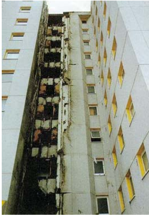
Şekil 4.44 Cephe kaplamasının yanıcılığı ve cephenin geometrik yapısı nedeniyle oluşan baca etkisinin yangını destekleyerek üst katlara yayması sonucu oluşan tahribat, Knowsley Heights, Liverpool, 1991, (Arpacıoğlu, 2004).
