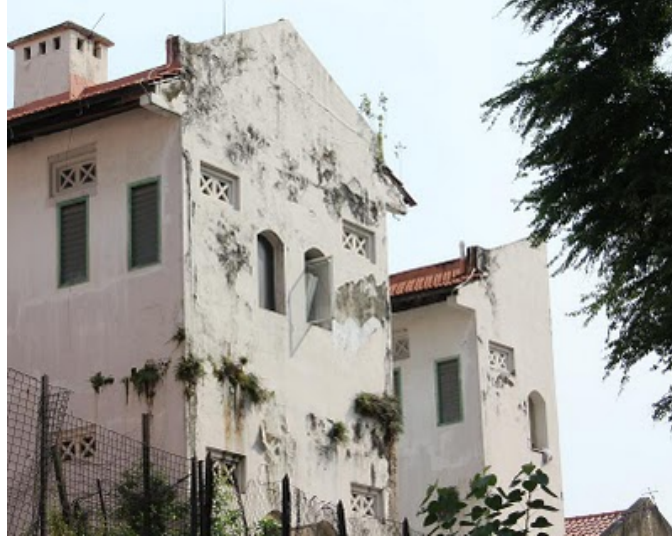
Şekil 3.14 Bina cephesinde biyolojik büyüme nedeniyle oluşan kirlenme (URL-17)
