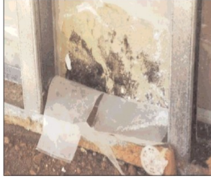
Şekil 5.10 Duvarın iç yüzeyinde küf oluşumu (URL-59)
