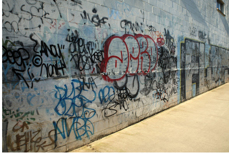
Şekil 3.15 Vandalizm nedeniyle kirlenmiş cephe (URL-18)
