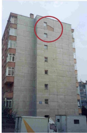
Şekil 3.7 Boyut kararlılığı olmayan malzemelerin cephe kaplama malzemesi olarak seçilmesi (yanlış ürün seçimi) (Güzelçoban, 2007).
