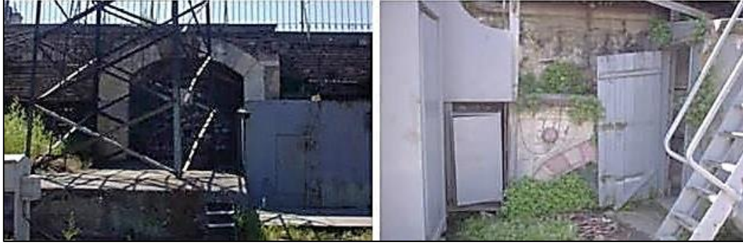
Şekil 4.5. Haliç Tersanesi'ne Ait Zaman İçinde Çevresindeki Yapılaşmalar Sonucu Kullanılamaz Hale Gelmiş Kısımlar ( www.halicdayanismasi.blogspot.com )
