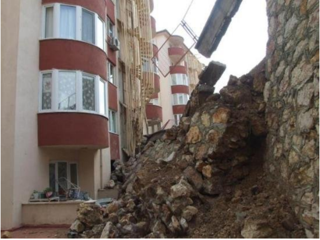
Şekil 1.2. Yıkılan istinat duvarı (www.insaatci.com)
