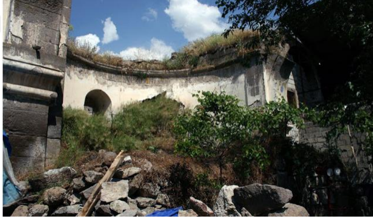
Şekil 38: Germir Surp Stepanos Kilisesi Apsis Duvarı [110]
